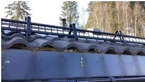
Isolasjon stikker frem under takstein.
