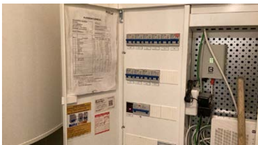
Kontroll av skap.
