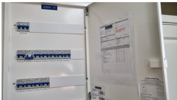
Kontroll av el-skapet.
