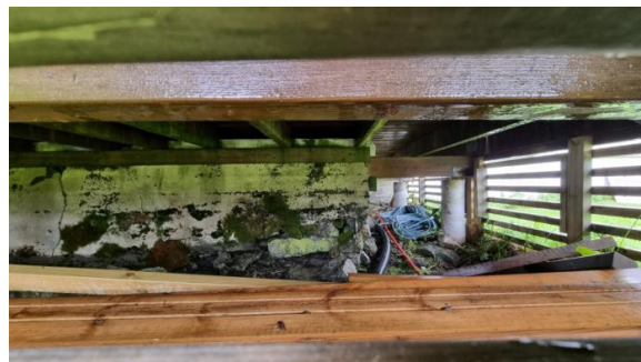
Sprekker og avskalling i grunnmur.
