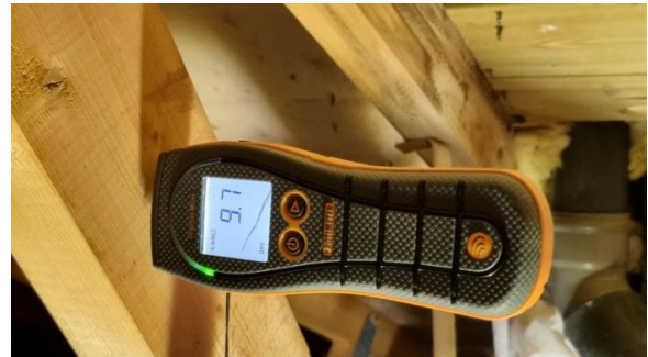
Forhøyede fuktverdier registrert ved luftelyren.
