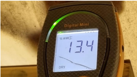
Fuktmåling i finerplater og andre steder på loftet. Ingen unormale fuktverdier ble her registrert, dette med unntak av ved luftelyren.
