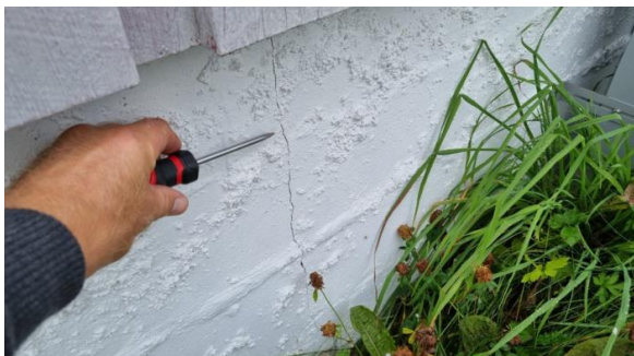
Sprekk i grunnmur.
