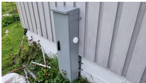
Måler er montert i utvendig skap.
