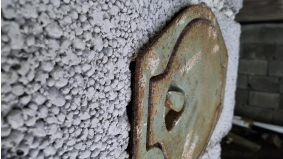
Kontroll av sotluken. Noe rust i sotluken.
