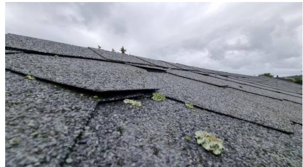
Enkelte "lepper" har blitt løftet av vind.
