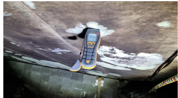
Fuktmåling i stubbloft, forhøyede fuktverdier ble registrert.
