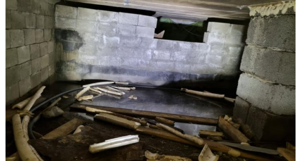
Stående vann i del av krypkjeller.
