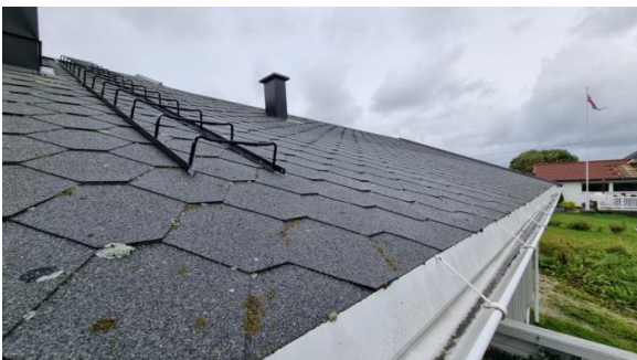
Stor avstand mellom takfot og stige.
