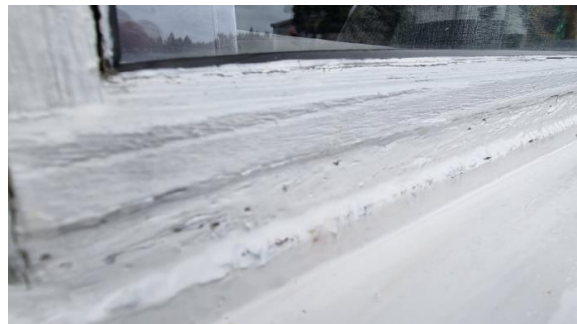
Stedvis begynnende svekkelser i utvendig treverk.
