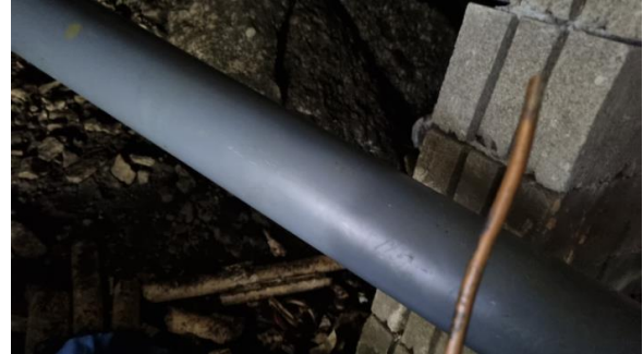
Avkappet kobberør i krypkjelleren som trolig har vært rør for fyringsolje.
