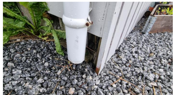
Takkvannet blir ikke tilfredsstillende ledet bort.
