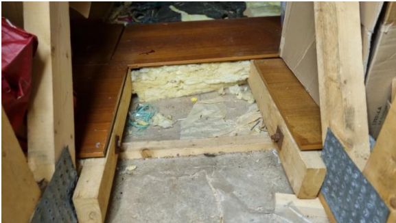
Manglende isolasjon rett ved luken.
