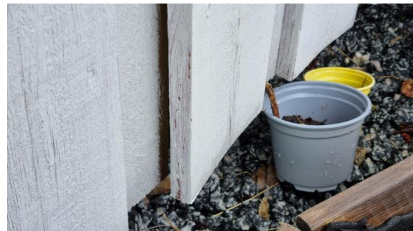
Stedvis vridninger i enkelte kledningsbord. Dette fører til liten tetting mellom kledningsbordene.
