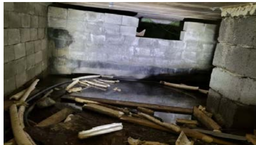
Stående vann i del av krypkjeller.
