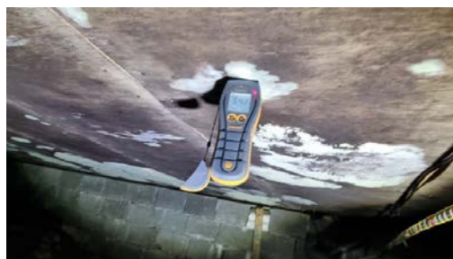
Fuktmåling i stubbloft, forhøyede fuktverdier ble registrert.
