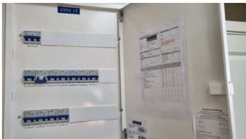
Kontroll av el-skapet.
