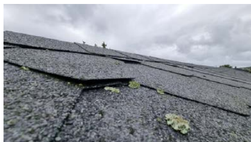
Enkelte "lepper" har blitt løftet av vind.
