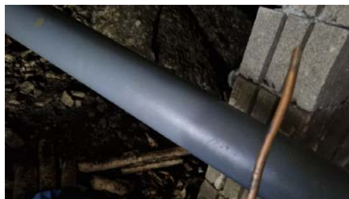
Avkappet kobberør i krypkjelleren som trolig har vært rør for fyringsolje.
