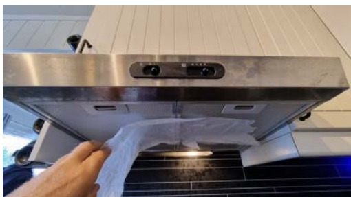
Funksjonstesting av det mekaniske avtrekket over koketoppen.
