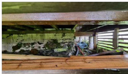
Sprekker og avskalling i grunnmur.
