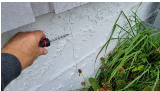
Sprekk i grunnmur.
