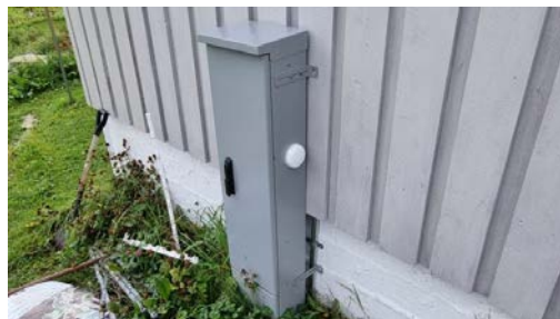
Måler er montert i utvendig skap.
