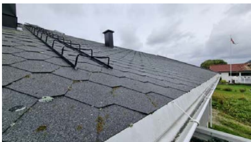
Stor avstand mellom takfot og stige.
