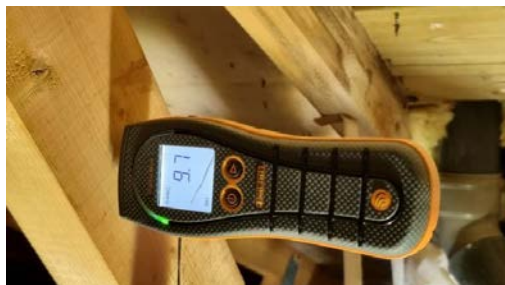
Forhøyede fuktverdier registrert ved luftelyren.
