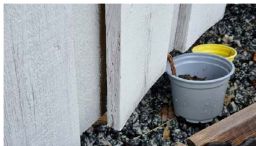
Stedvis vridninger i enkelte kledningsbord. Dette fører til liten tetting mellom kledningsbordene.
