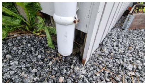
Takkvannet blir ikke tilfredsstillende ledet bort.
