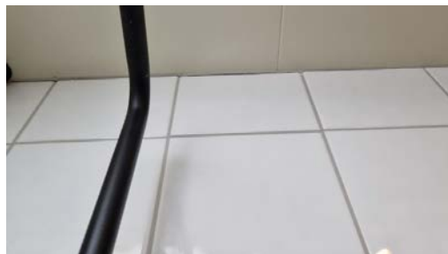
Glippe/utettheter mellom vegg og himling.
