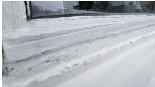
Stedvis begynnende svekkelser i utvendig treverk.
