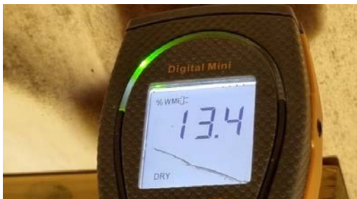
Fuktmåling i finerplater og andre steder på loftet. Ingen unormale fuktverdier ble her registrert, dette med unntak av ved luftelyren.
