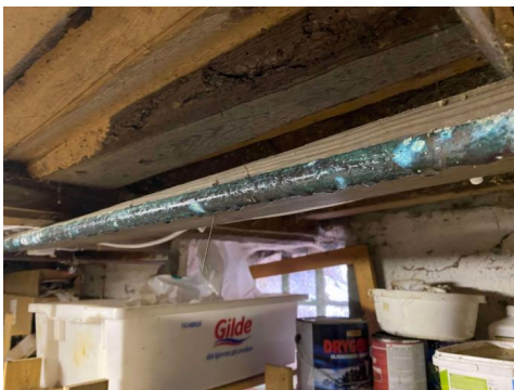
Irr på vannrør i kjeller
