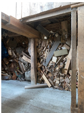
Åpninger i bjelkelag må utbedres.
