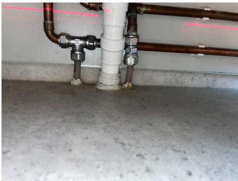
Ufaglig tetting rundt rørgjennomføringer i våtsoner.
