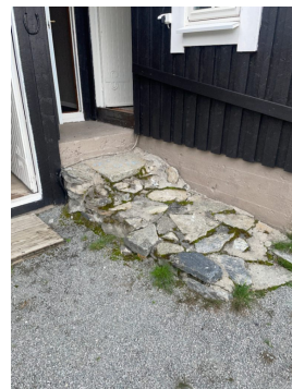
Trapp i betongkonstruksjoner med synlige sprekker
