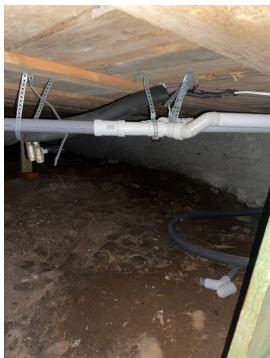
Stedvis manglende isolasjon på vannrør
