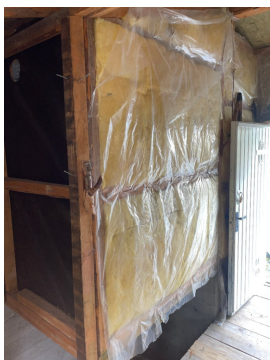
Isolasjon/plast mot bod bør utbedres forskriftsmessig
