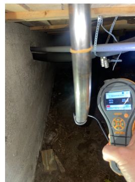
Det måles høye fuktverdier i stubbeloftsbord.
