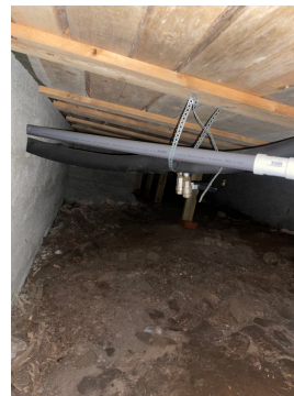
Manglende fuktsperre mot grunn
