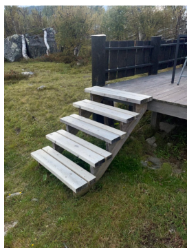
Konstruksjonen har skjevheter og mangler rekkverk
