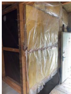
Isolasjon/plast mot bod bør utbedres forskriftsmessig
