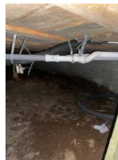
Avløpsrør er festet med patentbånd
