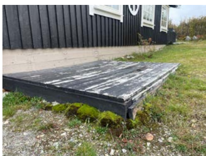
Platting ved hovedinngang har synlige skeivheter og manglende vedlikehold.
