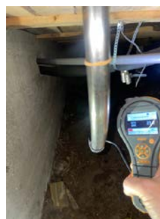
Det måles høye fuktverdier i stubbeloftsbord.
