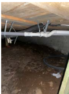
Stedvis manglende isolasjon på vannrør
