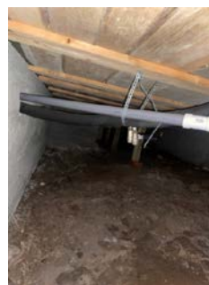
Manglende fuktsperre mot grunn
