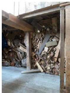
Åpninger i bjelkelag må utbedres.
