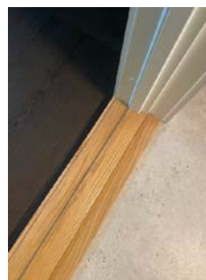
Avvik på membran høyde ved terskel.
