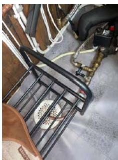
Ufaglig montering av vinylbelegg.
