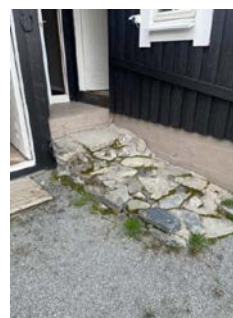
Trapp i betongkonstruksjoner med synlige sprekker
