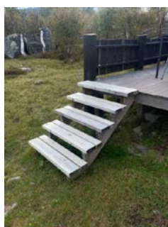
Konstruksjonen har skjevheter og mangler rekkverk
