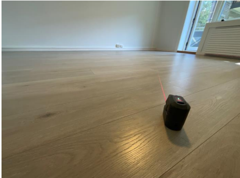
Nivellering stue/kjøkken, avvik ca. 10-20 mm
