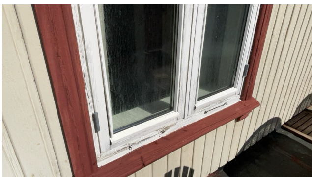
Værslitte vinduer ( her mot sør)
