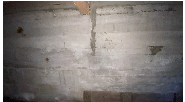
Sprekker i grunnmur
