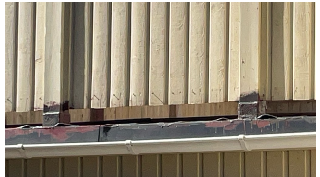
Membran har stedvis løsnet noe fra beslag i front.
