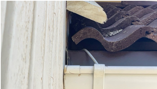
Undertak er ikke ført opp bak kledningen.
