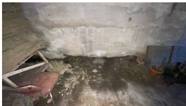
Synlig fuktinnsig mellom grunnmur-berg
