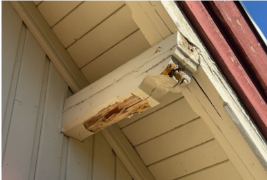
Råteskader i utvendige konstruksjon mot sør
