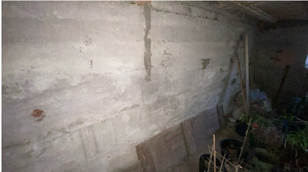
Sprekker i grunnmur
