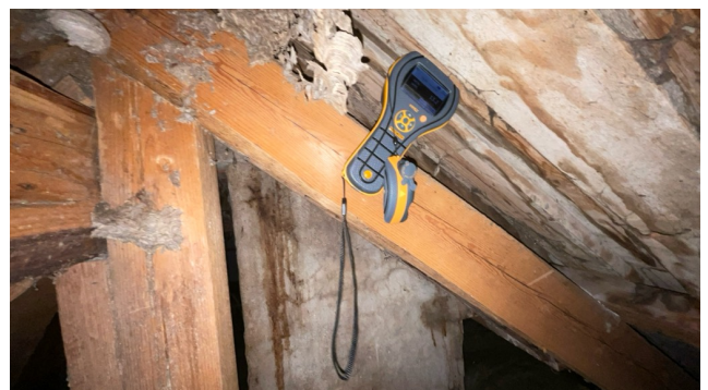
Ingen forhøyede fuktverdier er målt. Eldre angrep etter husbukk.
