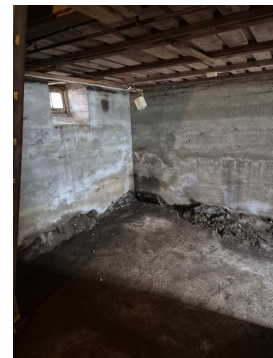
Fuktinnsig langs grunnmur-fjell
