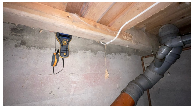
Det er registrert mindre forhøyninger av fukt med måleinstrument i bjelkelag mot grunnmur.
