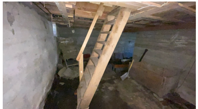
Bratt trapp som ikke har egnet bruksfunksjon
