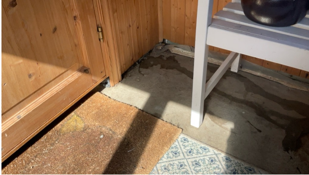
Synlig lekkasje etter fasade vask
