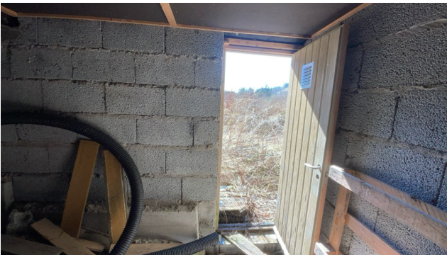
Begrenset ventilasjon av rommet.
