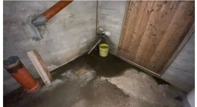
Fuktinnsig på gulv
