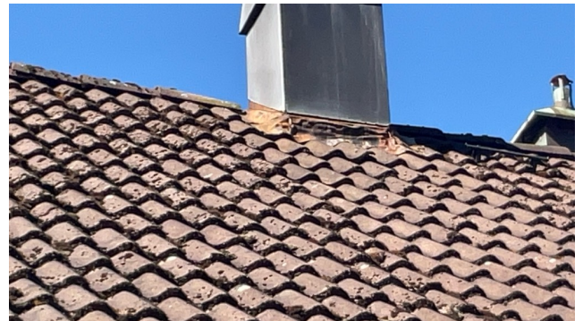
Økende slitasje på pipe
