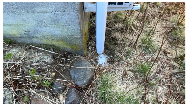
Ikke alle nedløp har bortledning av overflatevann
