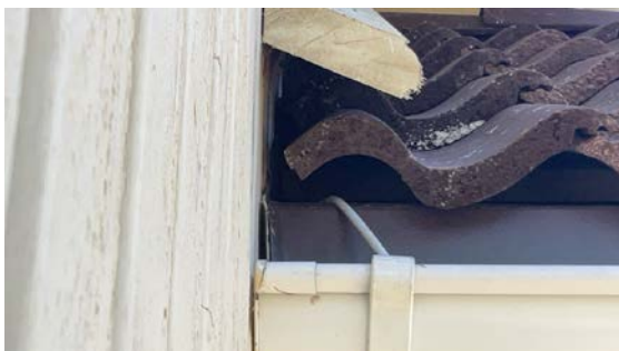
Undertak er ikke ført opp bak kledningen.
