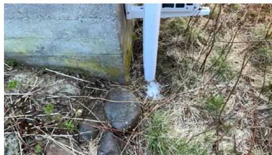
Ikke alle nedløp har bortledning av overflatevann
