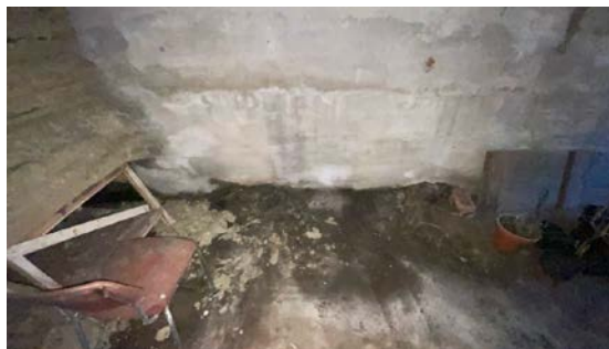
Synlig fuktinnslag mellom grunnmur-berg
