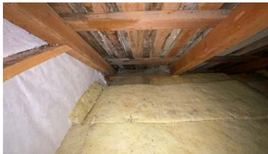
Begrenset lufting fra hyllebord
