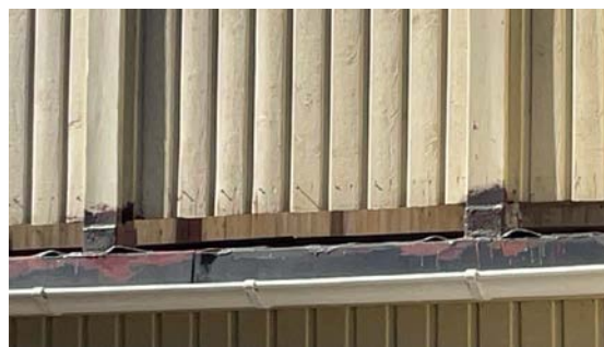
Membran har stedvis løsnet noe fra beslag i front.
