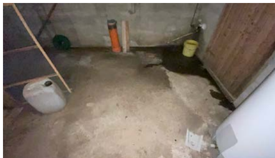
Synlig fuktinntrengning i kjeller
