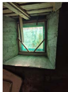
Kjellervinduer må oppgraderes omgående.
