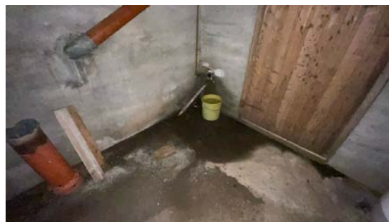
Fukttinnslag på gulv
