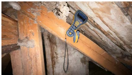
Ingen forhøyede fuktverdier er målt. Eldre angrep etter husbuk.
