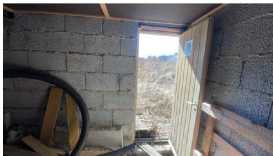
Begrenset ventilasjon av rommet.
