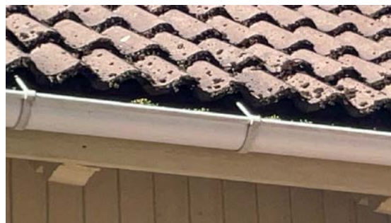
Takrenner ses stedvis fulle med vegetasjon
