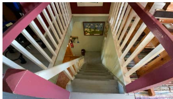
Trappen er nokså bratt og lite egnet for trapp mellom boligrom.
