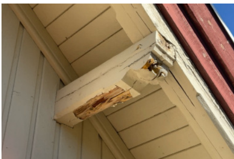
Råteskader i utvendige konstruksjon mot sør
