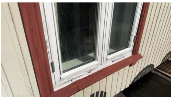
Værslitte vinduer ( her mot sør)
