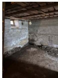
Fukttinnslag langs grunnmur-fjell
