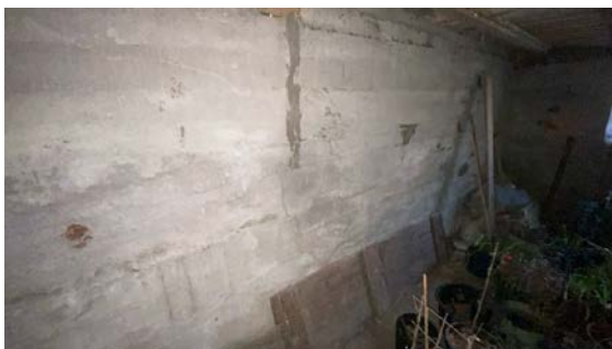
Sprekker i grunnmur
