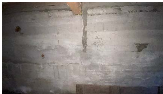
Sprekker i grunnmur
