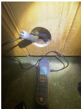
Råte i utlektning ved hulltagning innerste rom
