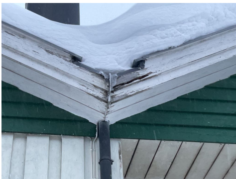
Råte tilbygg hvor tak går imot hverandre
