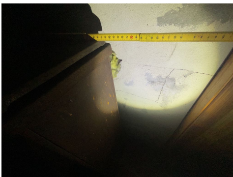
Røykrørsinnføring m/mineralull og kort avstand til treverk vedovn kjeller.
