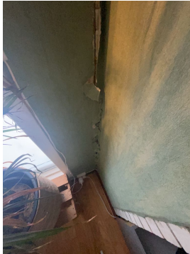
Større oppsprekk stuevegg mot opprinnelig del.
