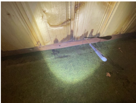
Fuktskjolde/råte nedkant innerste rom
