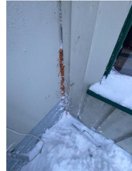
Sprekk m/byggsaum mellom murvegg og trevegg stue
