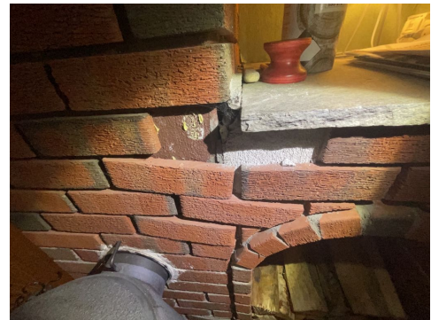
Skjev og løsnet limtegl
