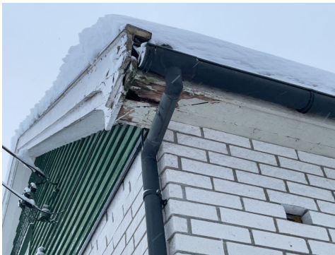
Råte gessims opprinnelig del
