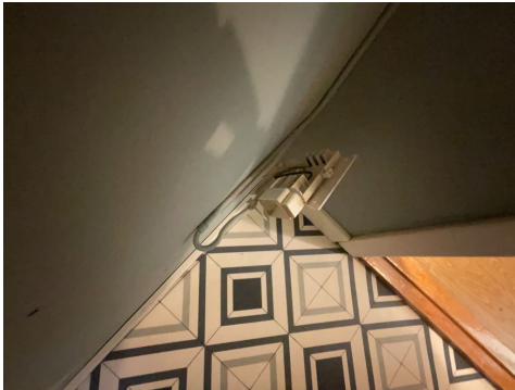
Løs feste for kobling til varmeovn vaskerom.
