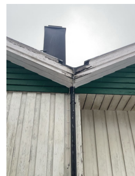
Uheldig løsning- varmekabel lagt- råde i takutstikket
