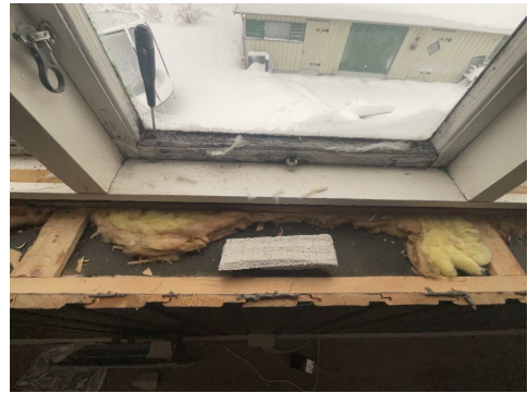
Råte i gammelt vindu 2.etg.
