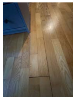
Oppsprekk gulv (i overgang tilbygg)
