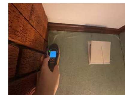
Limslipp/pløsing uthakk stuevegg (råte i takutstikk utv., men ikke målt unormal fukt inv. befaringsdagen).
