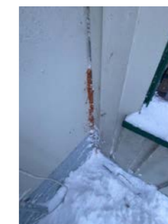
Sprekk m/byggsaum mellom murvegg og trevegg stue
