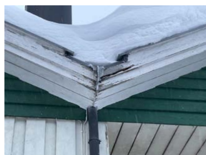
Råte tilbygg hvor tak går imot hverandre
