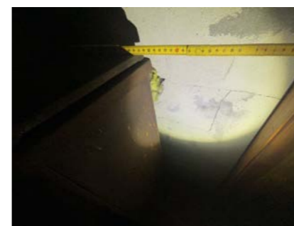
Røykrørsinnføring m/mineralull og kort avstand til treverk vedovn kjeller.
