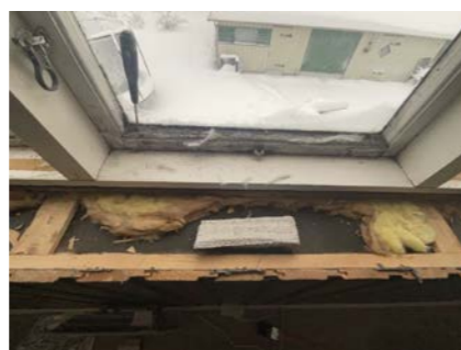
Råte i gammelt vindu 2.etg.
