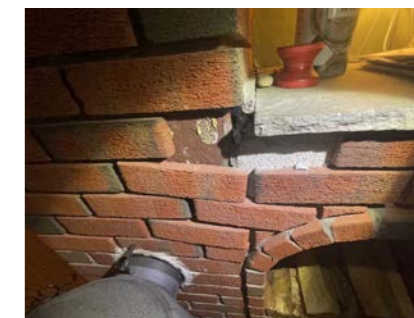
Skjev og løsnet limtegl
