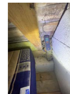
Ising og fuktig ved uventilert raft
