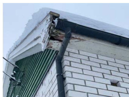
Råte gessims opprinnelig del
