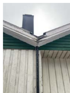
Uheldig løsning- varmekabel lagt- råte i takutstikket
