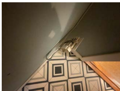
Løs feste for kobling til varmeovn vaskerom.
