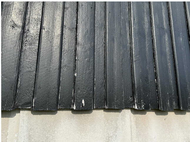
Fuktpåkjent med flasse maling
