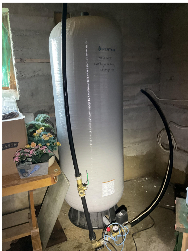
Trykktank fra 2017, stoppekran, vann fra grunnborret vannkilde
