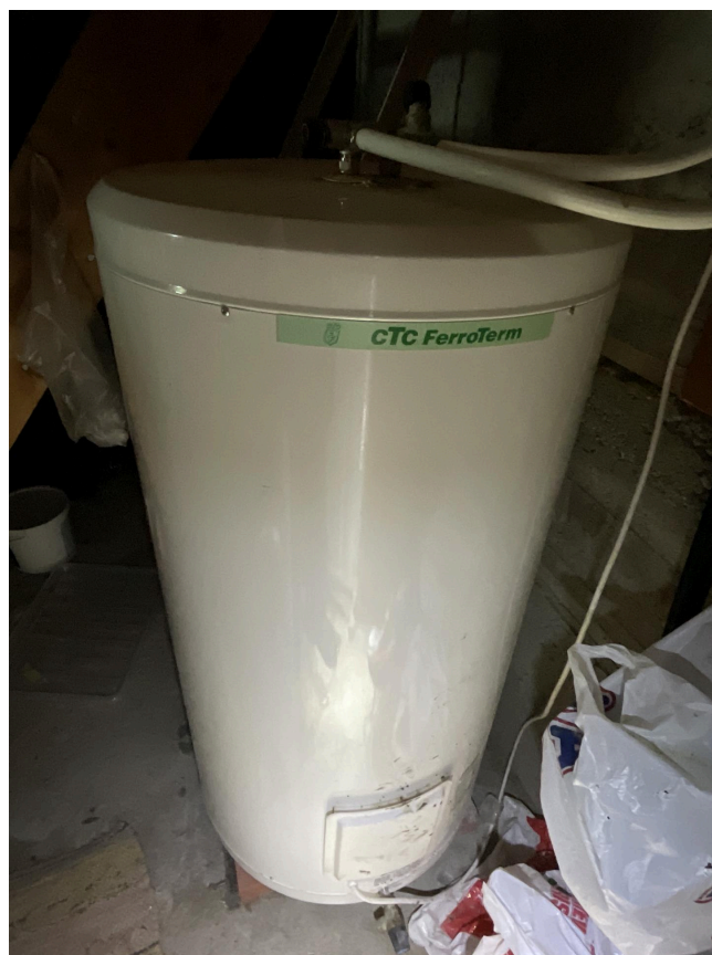
Varmtvannsbereider fra 2003, 200l
