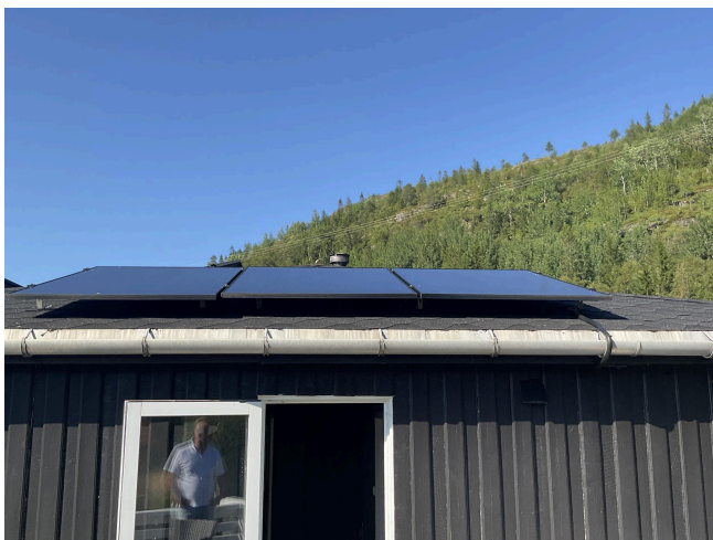
Utvendig solcellepanel på tak
