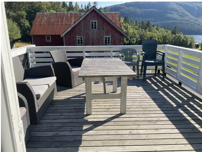
Balkong over borom. Trepallegulv, tekt med papp under. Rekkverk av malt tre litt for lavt ihht dagens krav
