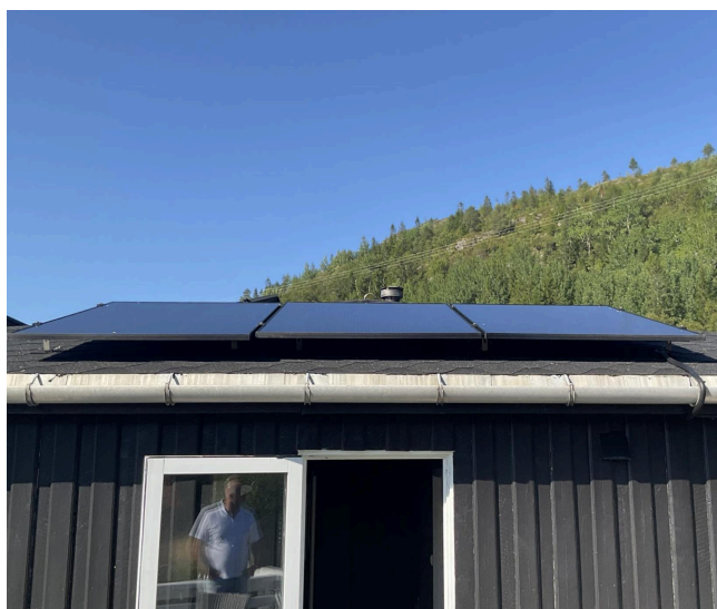
Utvendig solcellepanel på tak
