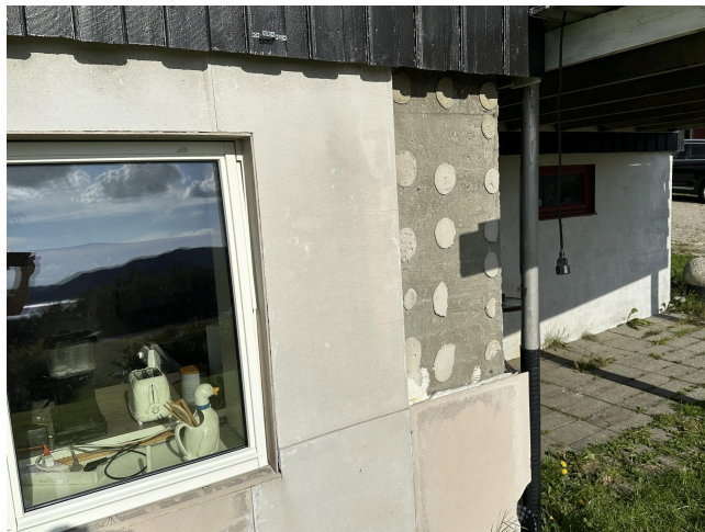
Fasadeplate m/pålimt isoporplate har løsnet.
