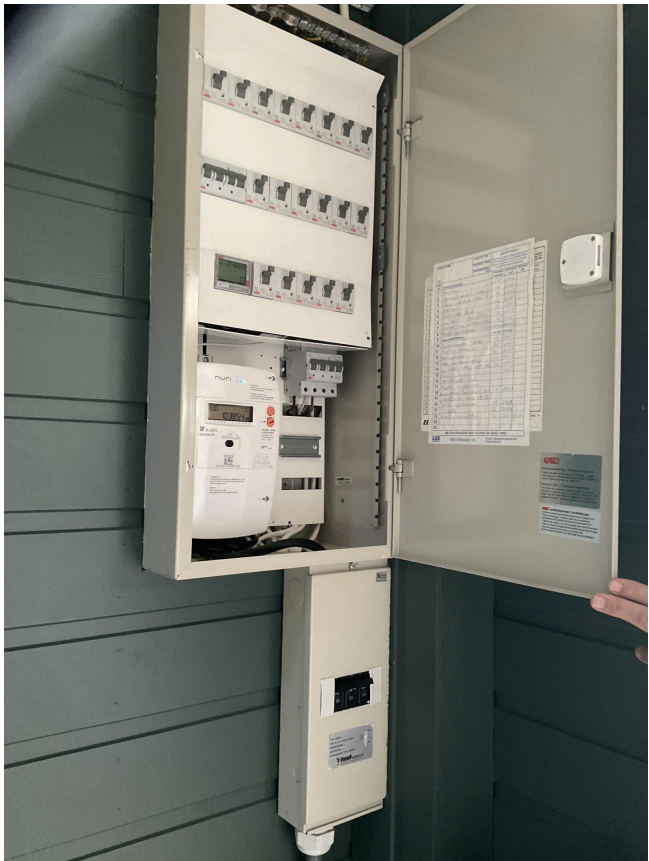
Nytt sikringsskap med automatsikringer + hovedsikringbox.
