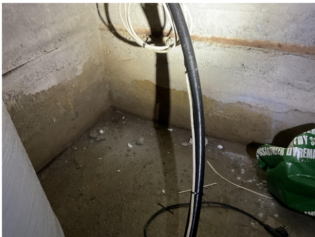
Fuktig gulv og grunnmur ved trykktank
