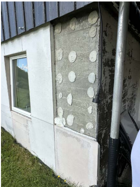
Grunnmur er forblendet med isoporplater/fassadeplater -registrert løs plate
