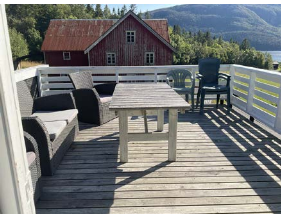
Balkong over borom. Trepaltegulv, tekt med papp under. Rekkverk av malt tre litt for lavt ihht dagens krav
