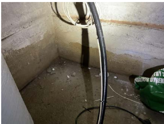
Fuktig gulv og grunnmur ved trykktank
