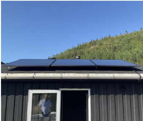
Utvendig solcellepanel på tak
