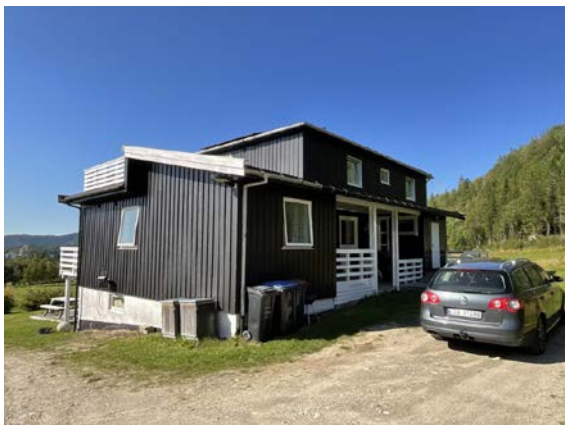
Feil hellingsgrad fra grunnmur og utover
