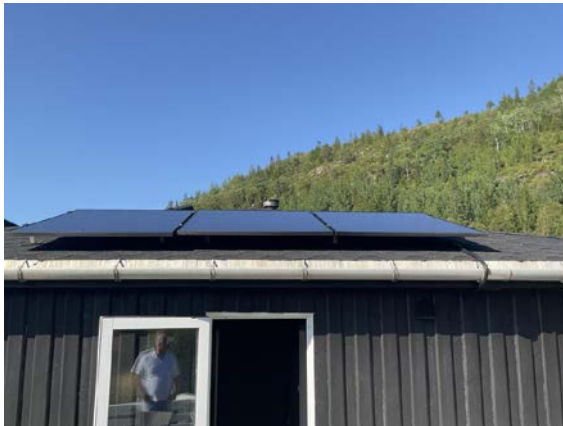
Utvendig solcellepanel på tak
