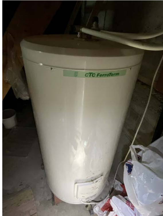
Varmtvannsbereder fra 2003, 200l
