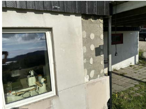
Fasadeplate m/pålimt isoporplate har løsnet.
