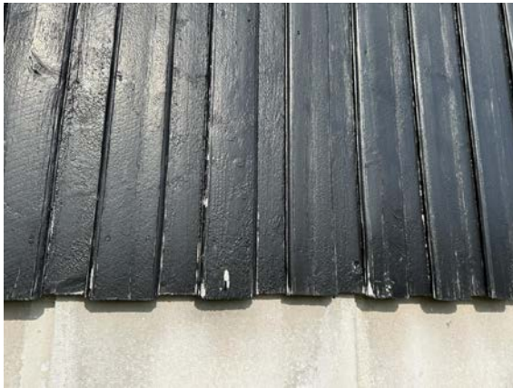
Fuktpåkjent med flasse maling
