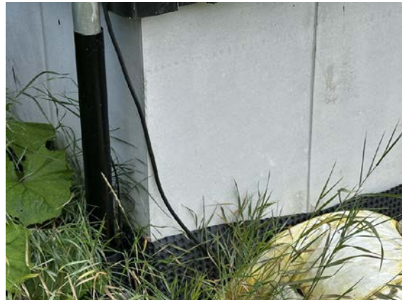
Grunnmursplast mangler topplist
