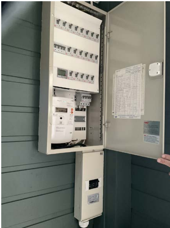
Nytt sikringsskap med automatsikringer + hovedsikringbox.
