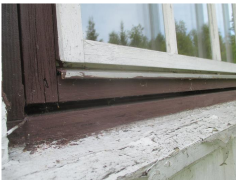
En del slitasje på utvendig karm og ramme.
