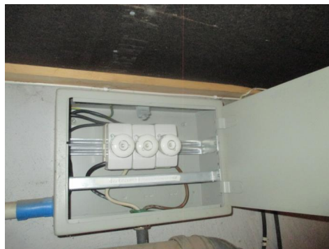
Hovedinntaket i grovkjeller.
