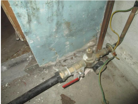
Innvendig hovedstoppekran i grovkjeller.
