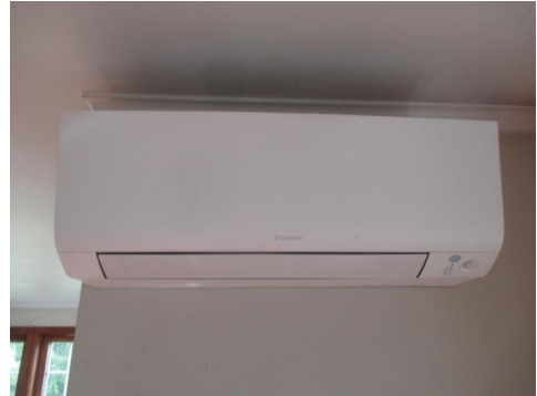
Varmepumpe i stue.
