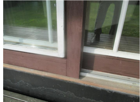
Skyvedør er blitt noe slitt.
