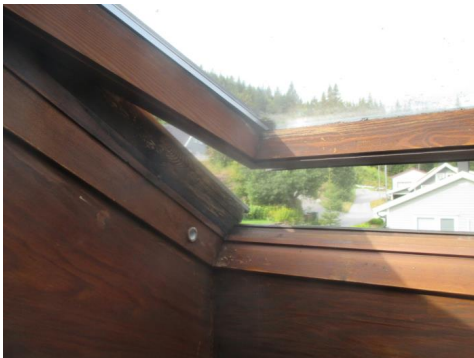
Eldre noe slitt takvindu.
