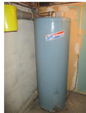
Bereder er plassert i grovkjeller.
