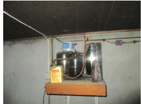
Aggregatet er plassert i grovkjeller
