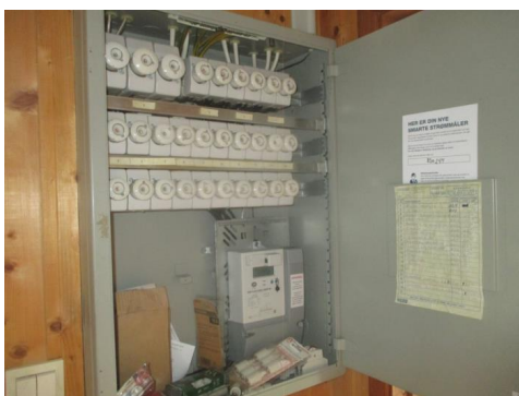
Sikringsskapet er plassert i vindfang.
