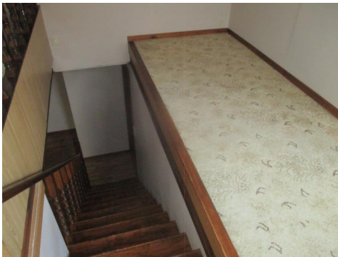
Mangler rekkverk på toppen av trappen på ene siden.
