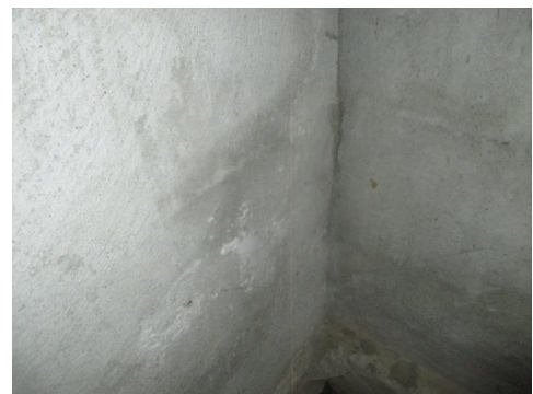
Noe saltutslag og fuktvandring i grunnmur.
