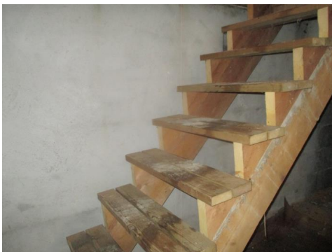
Enkel trapp til grovkjeller som ikke tilfredstiller dagens krav til sikkerhet.
