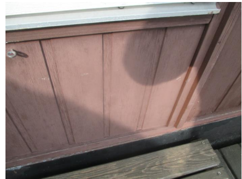
Slitt tofløyet balkongdør.
