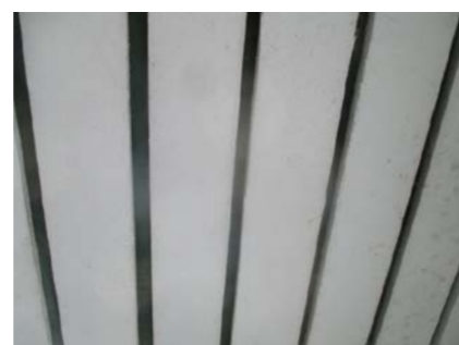
Gode luftespalter i gesimsen.
