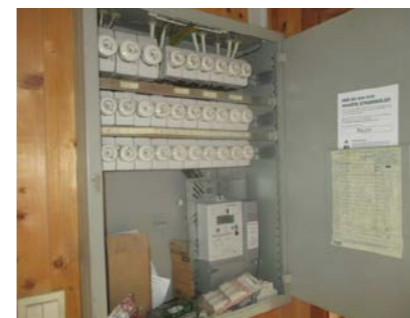
Sikringsskapet er plassert i vindfang.
