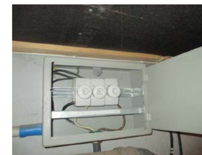
Hovedinntaket i grovkjeller.
