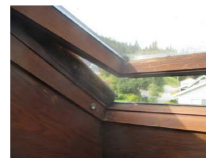
Eldre noe slitt takvindu.
