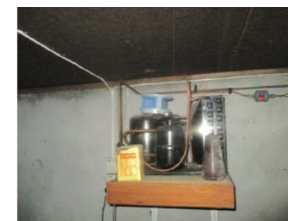
Aggregatet er plassert i grovkjeller
