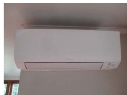
Varmepumpe i stue.
