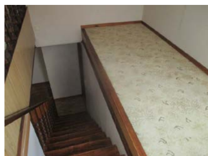
Mangler rekkverk på toppen av trappen på ene siden.
