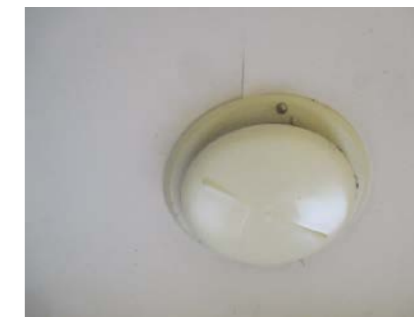
Naturlig avtrekk i himling.
