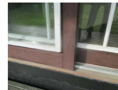
Skyvedør er blitt noe slitt.
