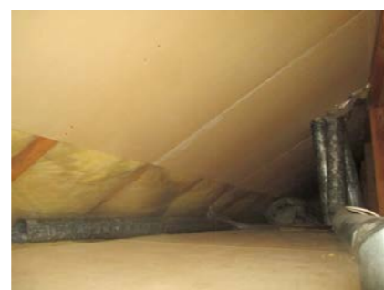
Varme knekott som er isolert helt ned til svill.
