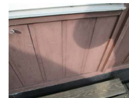
Slitt tofløyet balkongdør.
