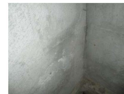
Noe saltutslag og fuktvandring i grunnmur.
