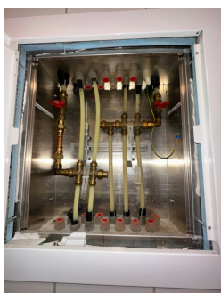
Samleskap med rørkurser og stoppekraner
