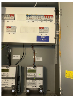
Sikringsskap med automatsikringer.
