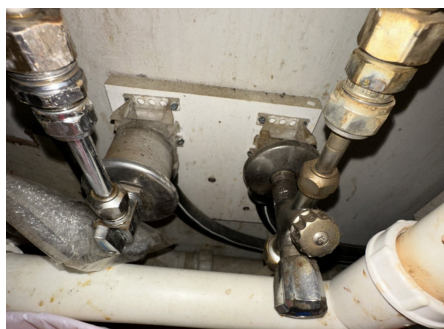
Røropplegg i kjøkkenbenk
