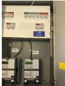
Sikringsskap med automatsikringer.
