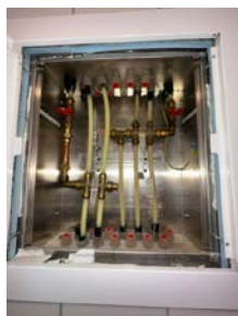
Samleskap med rørkurser og stoppekraner
