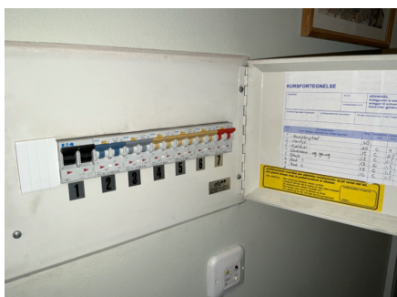
Automatsikringer i sikringsskap plassert i entré.
