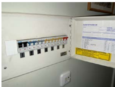
Automatsikringer i sikringssskap plassert i entré.
