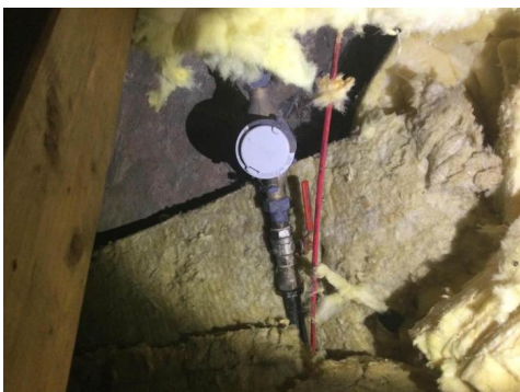
Stoppekran og vannmåler.
