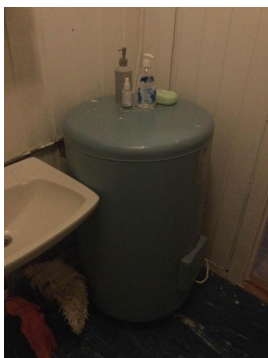
Eldre varmtvannstank på badetrom 2 etasje.
