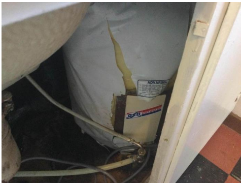
Varmtvannstank under kjøkkenbenk.
