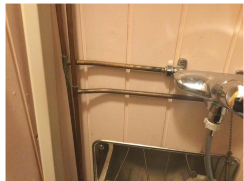
Rør ført synlig på vegg.
