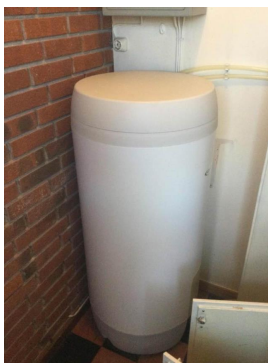
Ny varmtvannstank på kjøkken 1 etasje.
