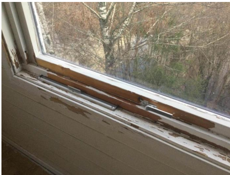
Slitasje på vindu.
