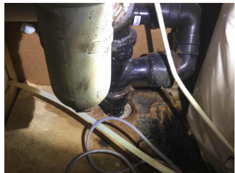
Avløpsrør i støpejern.
