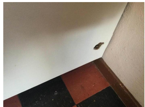
Skader på kjøkken.
