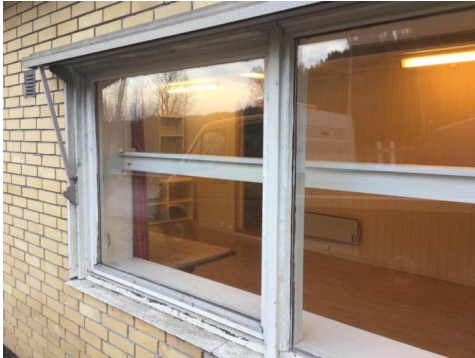
Slitasje på vindu.
