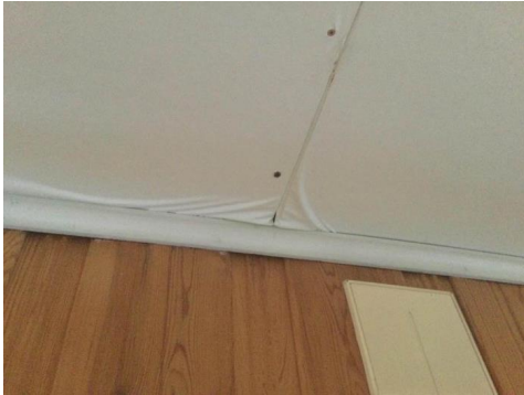
Skade på himlingsplater.
