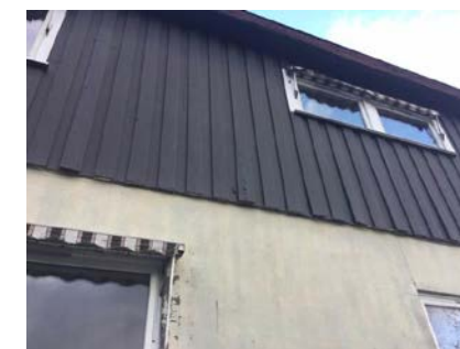
Bordkledning med sprekker og skader.
