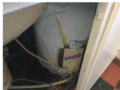
Varmtvannstank under kjøkkenbenk.
