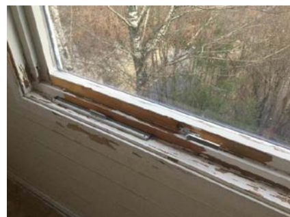
Slitasje på vindu.
