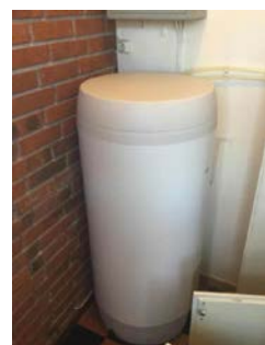
Ny varmtvannstank på kjøkken 1 etasje.
