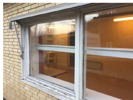
Slitasje på vindu.
