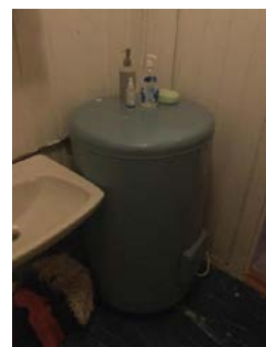
Eldre varmtvannstank på badrom 2 etasje.
