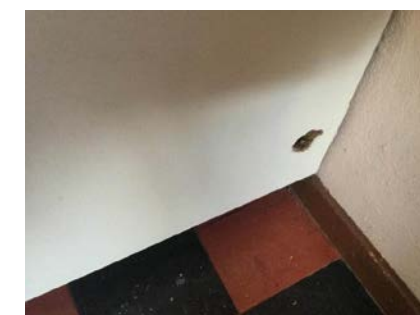
Skader på kjøkken.
