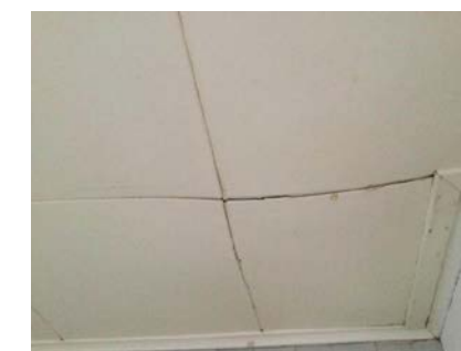
Skade på himlingsplater.
