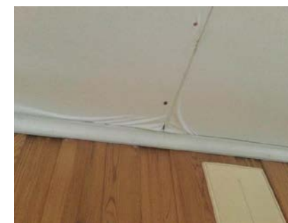
Skade på himlingsplater.
