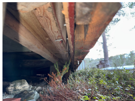
Viser villmarks kledning lagt på eldre kledning, redusert lufting og fare for punktering av eldre vindsperre
