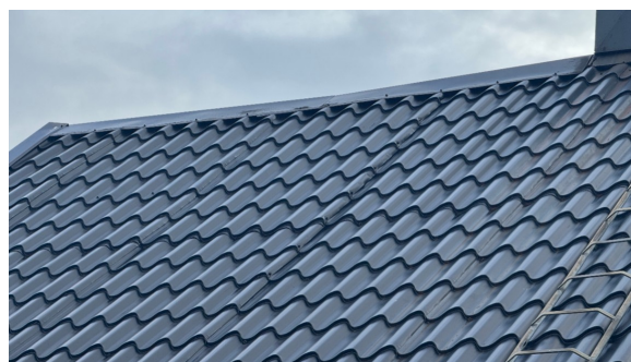
Det er påvist bulker i enkelte metallplater på taktekking
