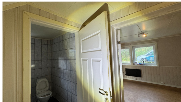
Skade i dørblad.
