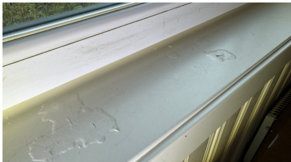
Fuktsvell og skader i vinduskarm.
