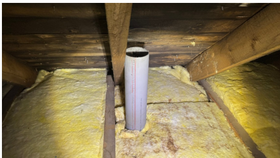
Luftingen av avløpsanlegget er avsluttet på kaldloftet.
