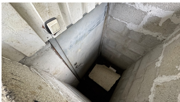
Kjellerdøren var låst ved befaring.
