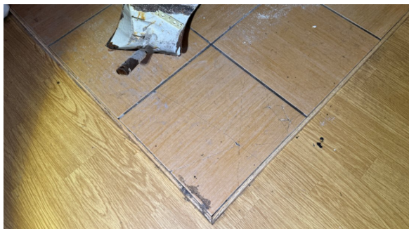
Det er sprekker i fliser under vedovnen.
