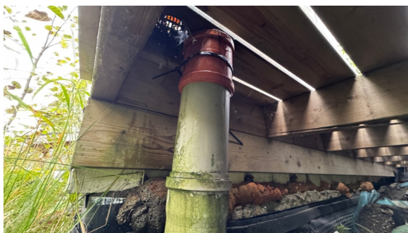
Enkelte nedløp er ikke tilkoblet dreneringssystemet.
