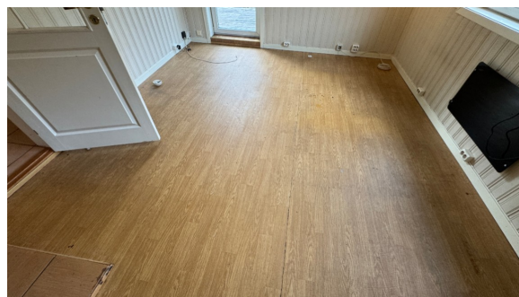
Det er målt en del planavvik i stuen.
