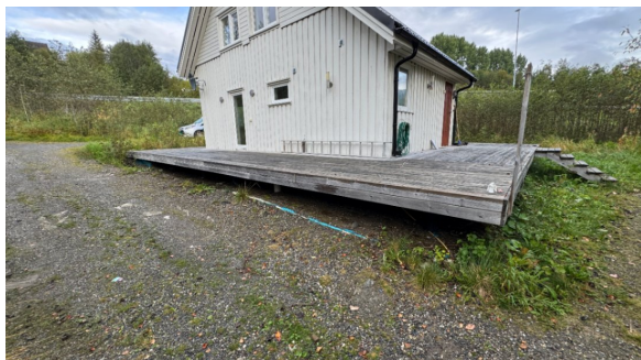
Det er ikke montert rekkverk.
