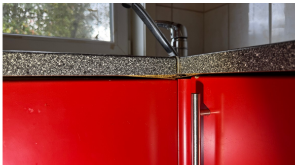
Fuktsvell i benkeplate.
