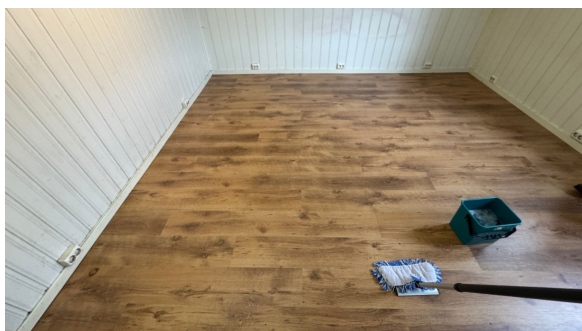
Største målte planavvik er målt på soverom i loftsetasjen.
