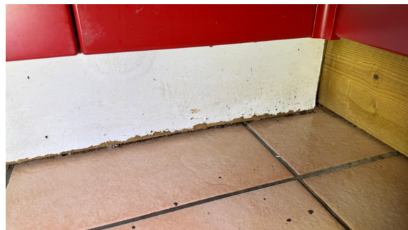
Fuktsvell i sokkel.
