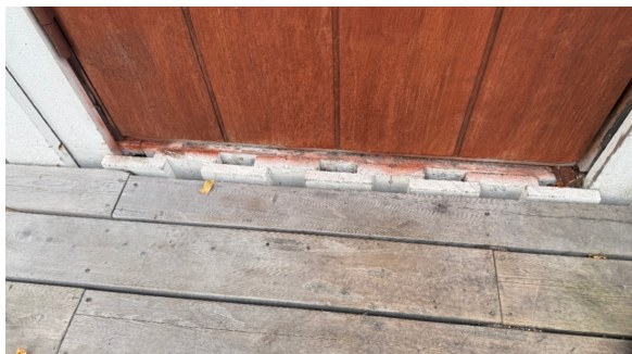
Dører mangler beslag i underkant.
