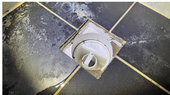
Ufagmessig utførelse rundt sluk. Det er ikke konstatert bruk av membran i gulvet.
