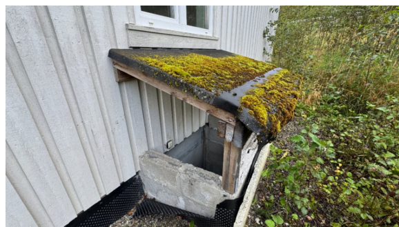
Det er ingen trapp til rom under terreng. Kun adkomst ved bruk av stige.
