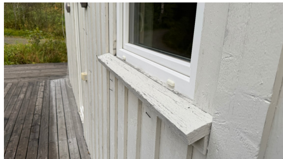
Utvendig omramming rundt vinduer er ufagmessig.
