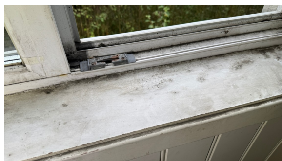
Fuktsvell og skader i vinduskarm.
