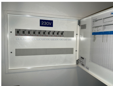
Bod plan 1: Automatsikringer i sikringskap.
