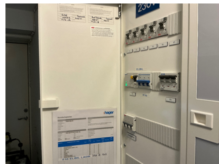
Bod underetasje: Automatsikringer i sikringskap.
