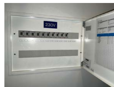
Bod plan 1: Automatsikringer i sikringskap.
