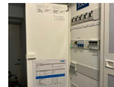
Bod underetasje: Automatsikringer i sikringskap.
