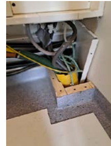
Inntaket av elektriske ledninger inn i bygget.
