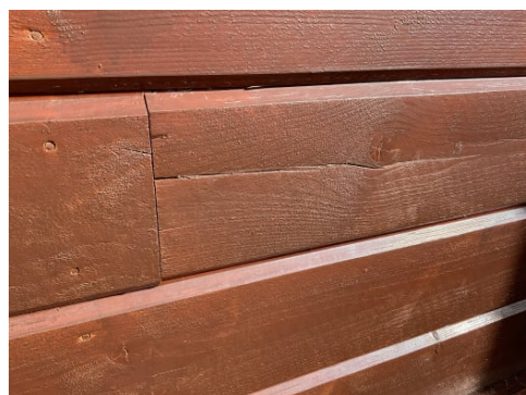
Sprekk i kledning.
