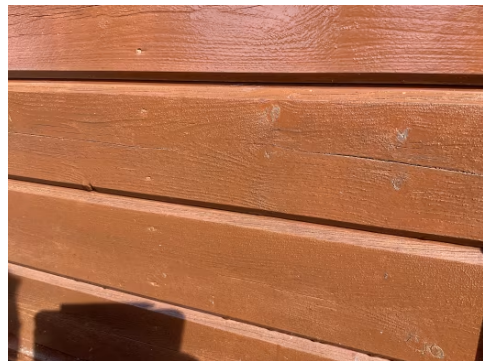
Sprekk i kledning.
