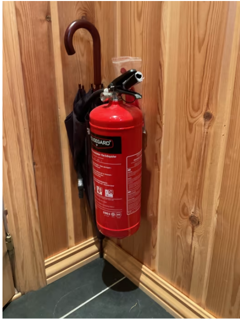
Brannslukker er plassert i gangl. etg.
