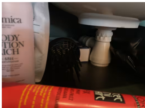
Avløpsrør for bad.
