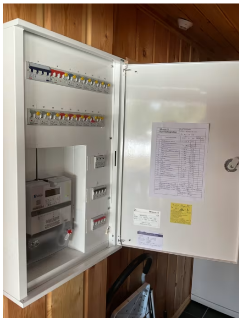
Sikringskap plassert i utvendig bod.
