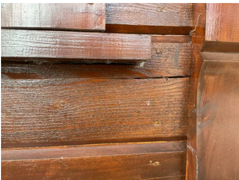
Sprekker i kledning.
