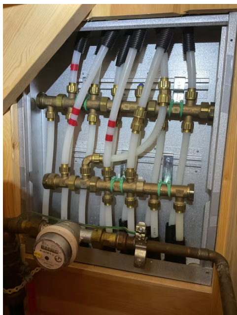
Fordelerskap til vann.
