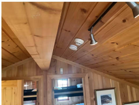
Røykvarsler i tak oppstue.
