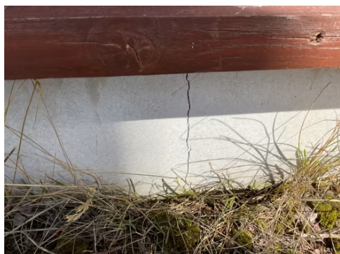
Sprekk i plate.
