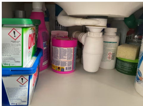
Avløpsrør for bad.
