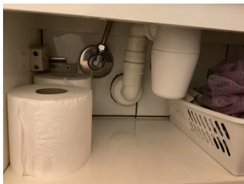
Avløpsrør for bad.
