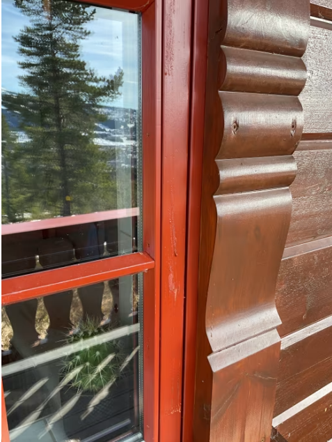
Utslag av kvae i karm.
