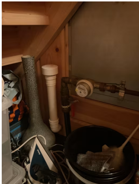
Lufting av kloakk gjennom vakuumventil.
