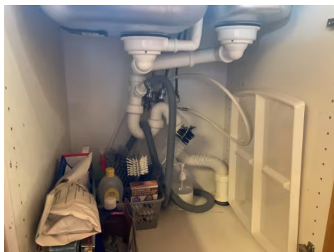
Avløpsrør for kjøkken.
