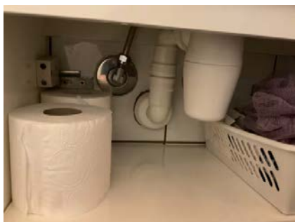
Avløpsrør for bad.
