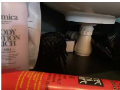
Avløpsrør for bad.
