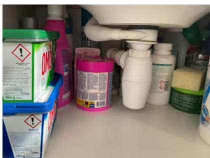
Avløpsrør for bad.
