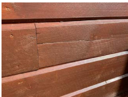
Sprekk i kledning.
