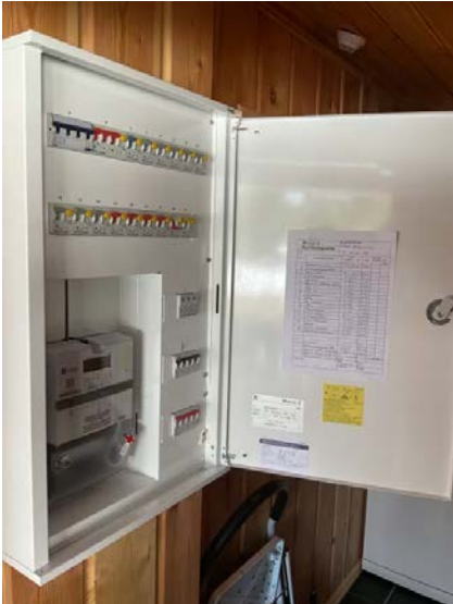
Sikringskap plassert i utvendig bod.
