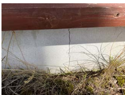
Sprekk i plate.
