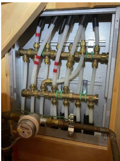
Fordelerskap til vann.
