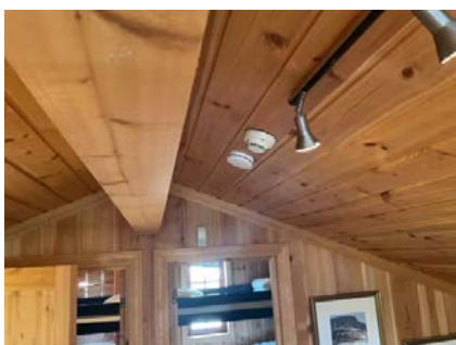
Røykvarsler i tak oppstue.
