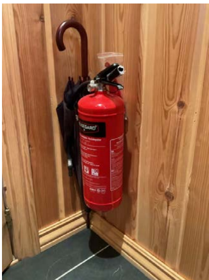
Brannslukker er plassert i gangl. etg.
