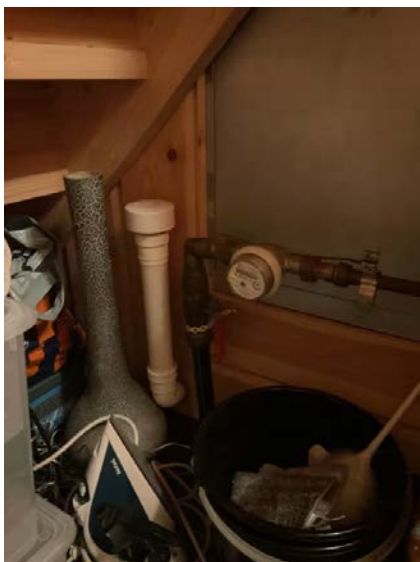
Lufting av kloakk gjennom vakuumventil.
