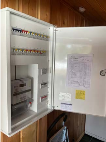
Sikringskap plassert i utvendig bod.
