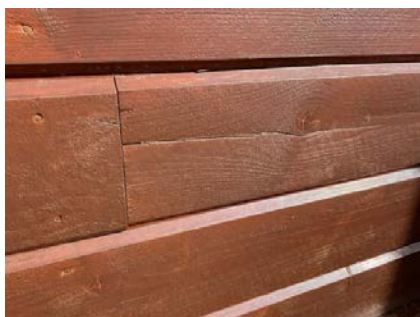
Sprekk i kledning.
