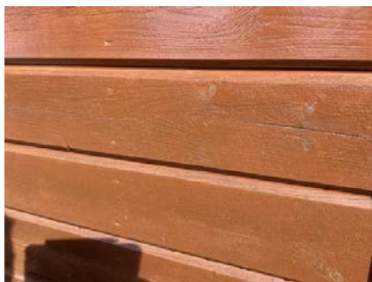
Sprekk i kledning.
