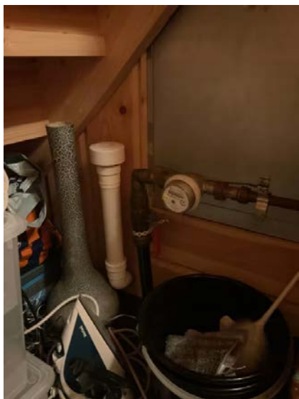
Lufting av kloakk gjennom vakuumventil.
