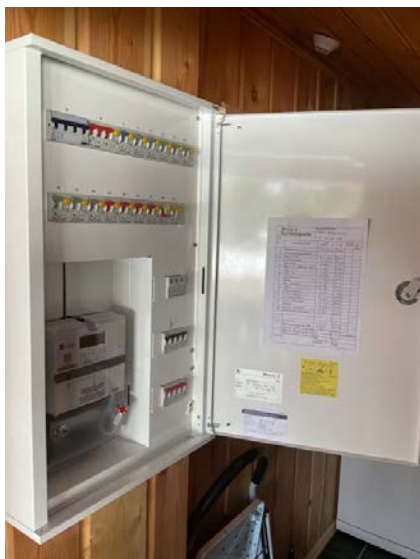
Sikringskap plassert i utvendig bod.
