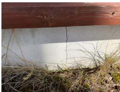
Sprekk i plate.
