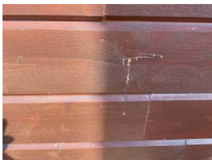
Utslag av kvæe.
