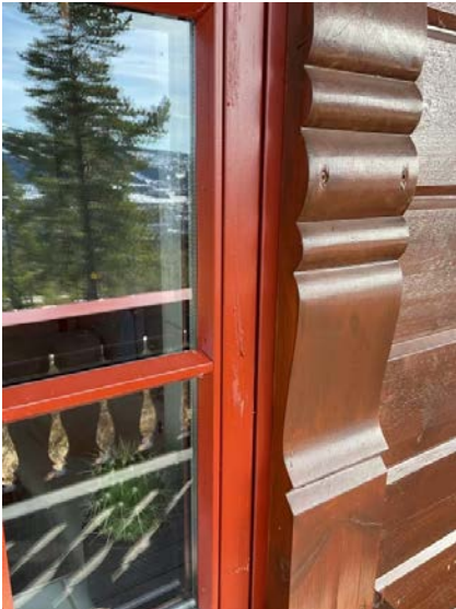
Utslag av kvae i karm.
