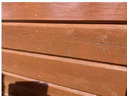
Sprekk i kledning.
