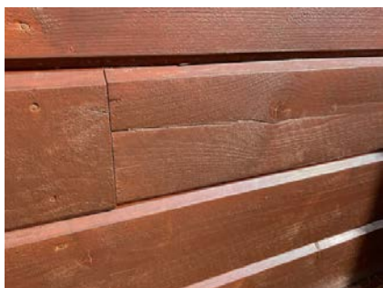
Sprekk i kledning.
