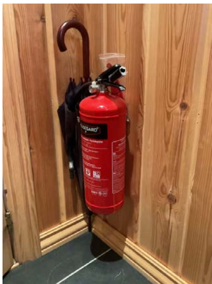
Brannslukker er plassert i gangl. etg.
