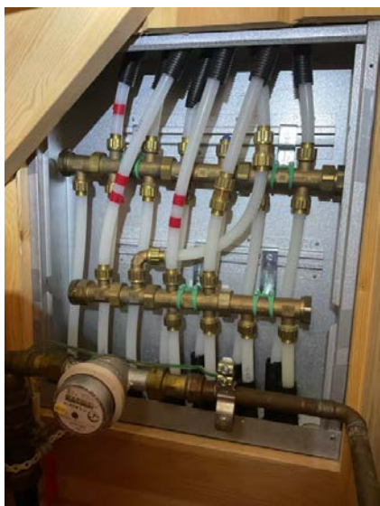
Fordelerskap til vann.
