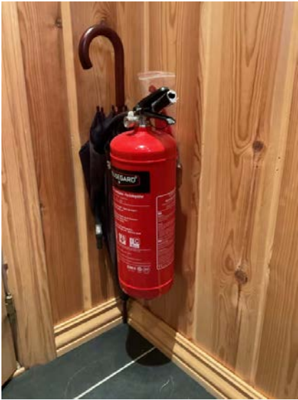
Brannslukker er plassert i gangl. etg.
