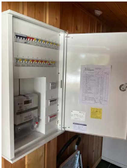
Sikringskap plassert i utvendig bod.
