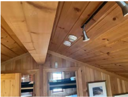
Røykvarsler i tak oppstue.
