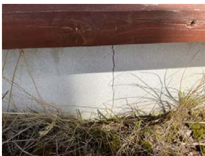
Sprekk i plate.
