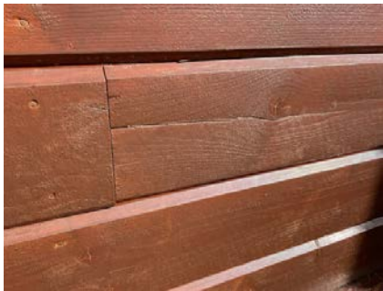
Sprekk i kledning.
