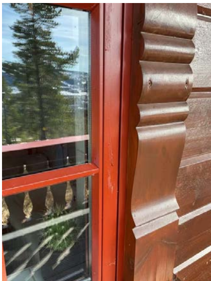
Utslag av kvae i karm.
