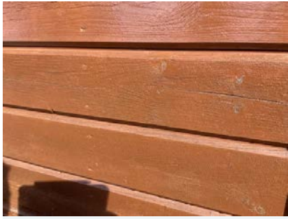
Sprekk i kledning.
