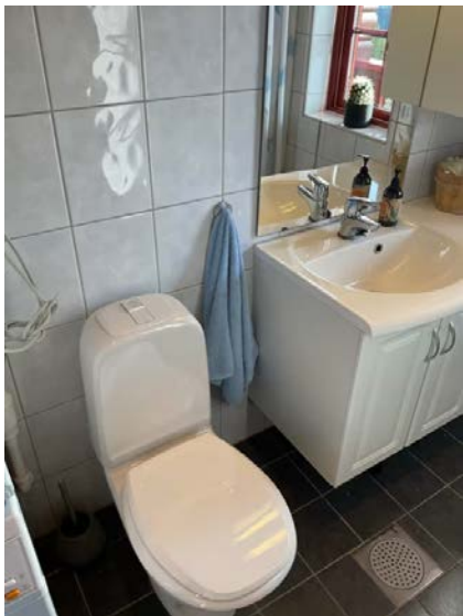
Sluk utenfor dusjsone.
