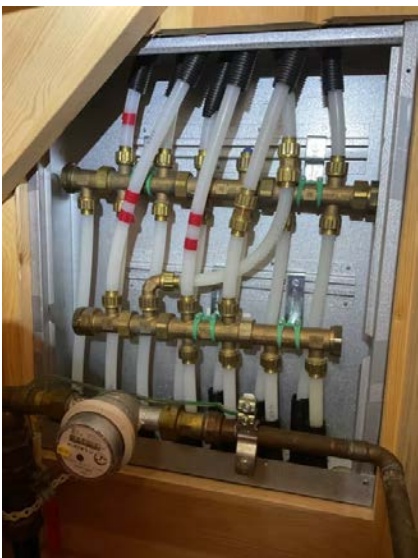
Fordelerskap til vann.
