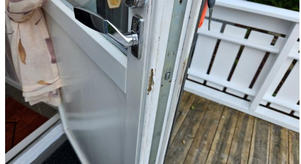
Defekt pakning på inngangsdør.
