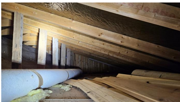
Taksperrer er noe underdimensjonert.
