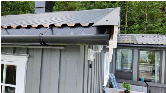
Det er registrert rust på takplater.
