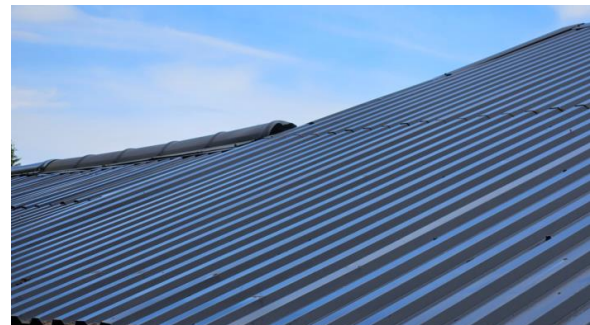
Det er ufagmessig avslutning på møne beslag mot hovedtak.
