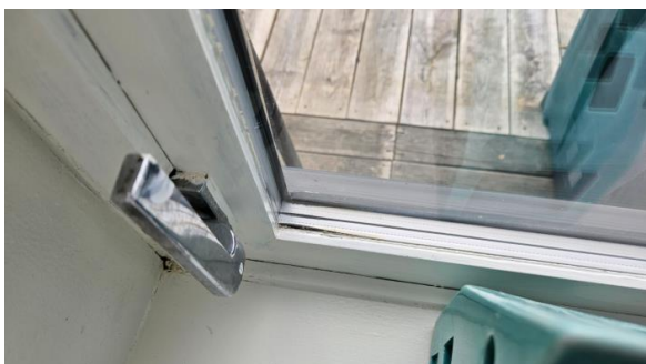
Tegn på kondensering innvendig.
