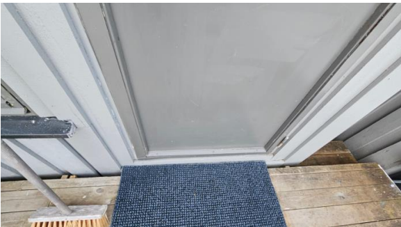
Fuktsvell i nedkant av dør blad.
