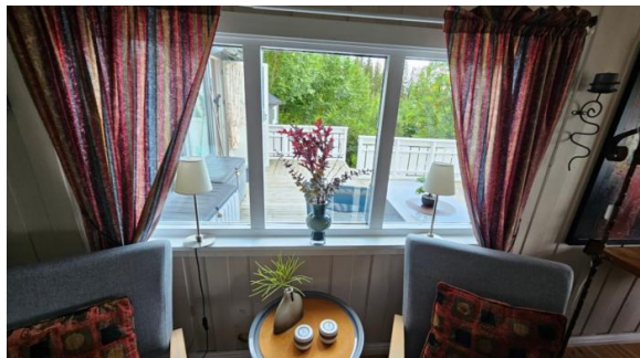
Vindu på stue er det ene glasset punktert (glass til venstre).
