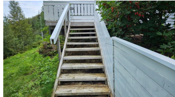
Det er ikke montert stakitt på rekkverk på trapp opp fra sti.
