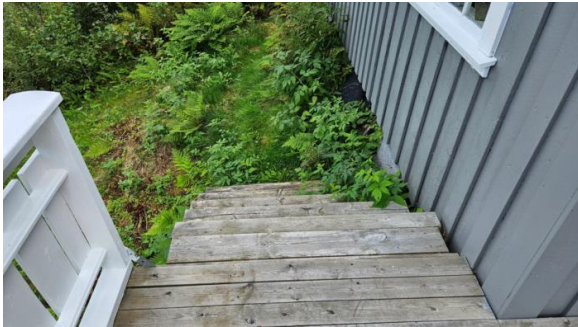
Det mangler rekkverk og håndløper på vegg.
