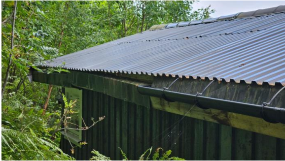
Takrenne på baksiden er defekt.
