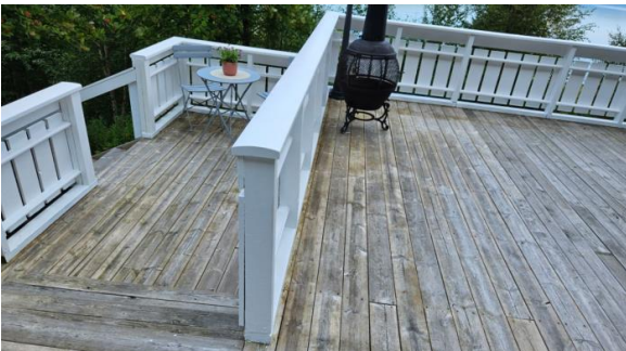
Rekkverk er ikke tilstrekkelig innfestet.
