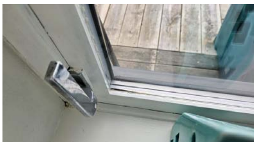
Tegn på kondensering innvendig.
