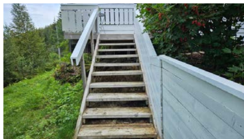
Det er ikke montert stakitt på rekkverk på trapp opp fra sti.
