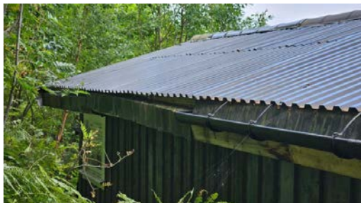
Takrenne på baksiden er defekt.
