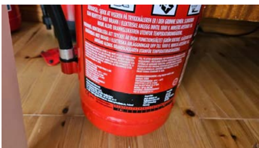
Brannslukningsapparat er eldre en 10 år.
