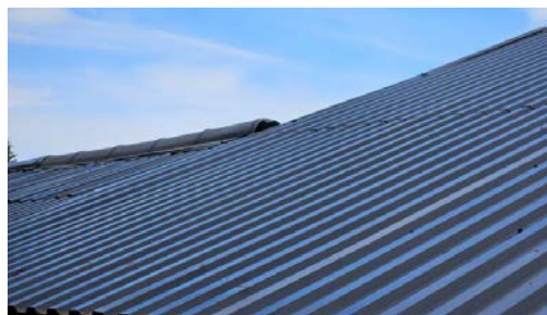
Det er ufagmessig avslutning på møne beslag mot hovedtak.
