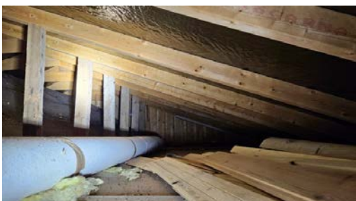
Taksperrer er noe underdimensjonert.
