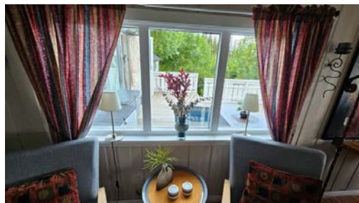
Vindu på stue er det ene glasset punktert (glass til venstre).
