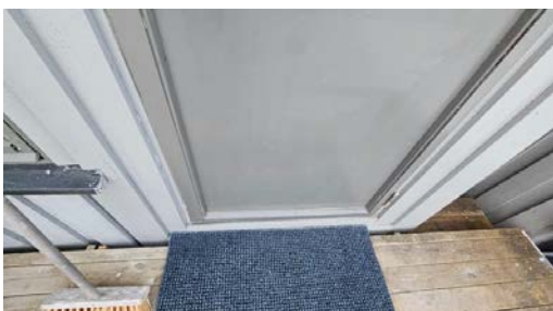
Fuktsvell i nedkant av dør blad.
