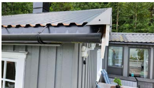
Det er registrert rust på takplater.
