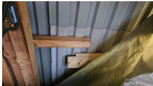
Under tak har falt ned.
