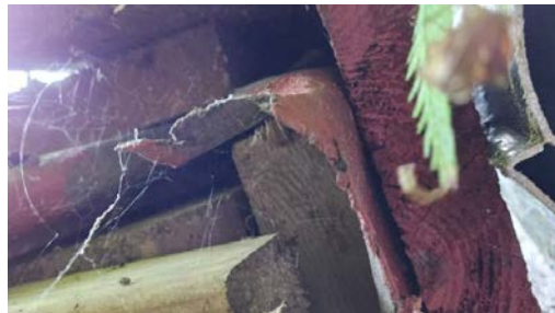
Det er ikke montert musebånd bak hjørnebord,
