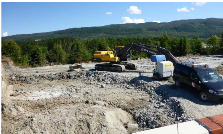
Figur 6.3 Avlastning av skråningstopp i Klæbu i Trøndelag. Foto: Geir B. Hagen, NVE
