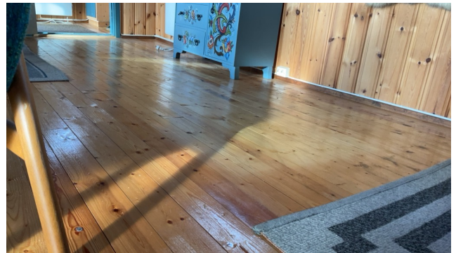
Det er registrert store skjevheter i gulv
