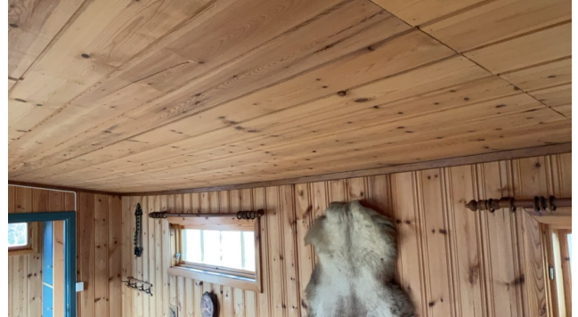
Det er registrert store skjevheter i tak og vegger
