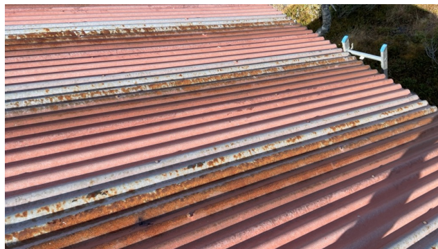
Rustskader på tekking
