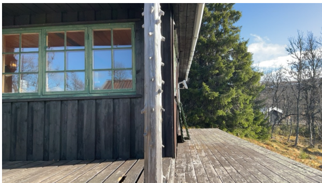
Skjevhet i vegg
