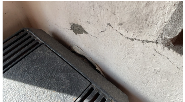
Avflassing bak vedovn mot pipe
