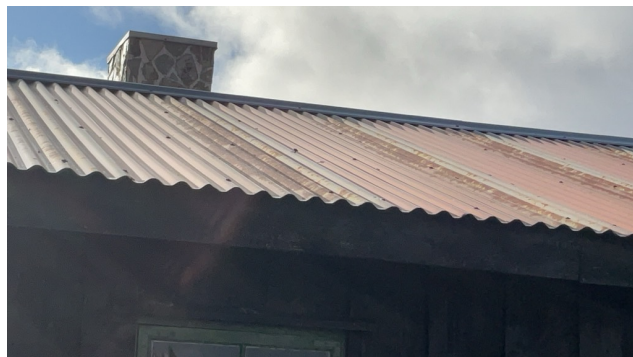
Spikeropptrekk på innfesting av tekking
