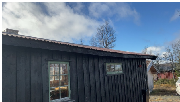
Skjevheter i takkonstruksjon
