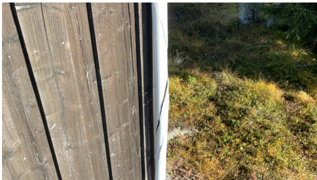
Skader på nedløp
