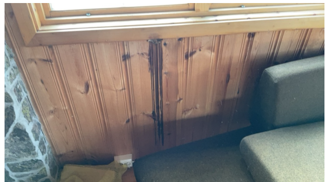
Det er fuktskjolder med avrenning på vegg ved vindu i stue
