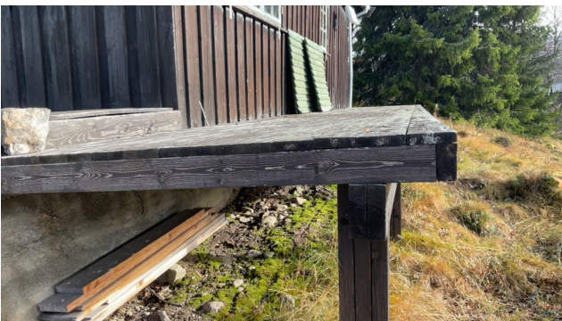
Skjevheter i konstruksjoner, enkel fundamentering der setninger fra grunn har forårsaket skjevheter i konstruksjonen
