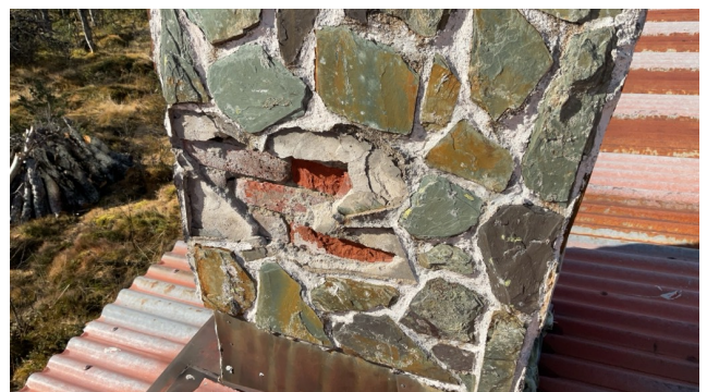
Skader på pipe over tak
