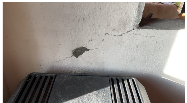
Sprekker i pipe/brannmur
