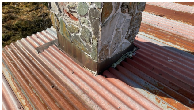
Bør foretas tiltak av pipebeslag der fotbeslag bør føres til møne
