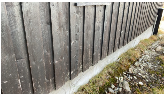
Slitasje og vedlikeholdsetterslep
