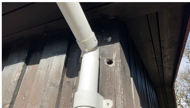
Skader med hakkespetthull
