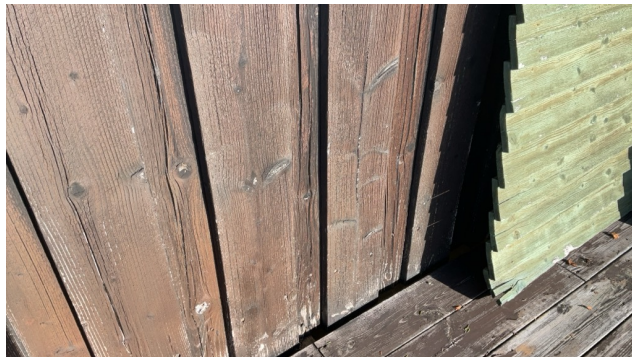
Sprekker i kledning der utskifting må påregnes på enkelte vegger spesielt solvendte, ellers anbefales etterisolering og etablering av lufting
