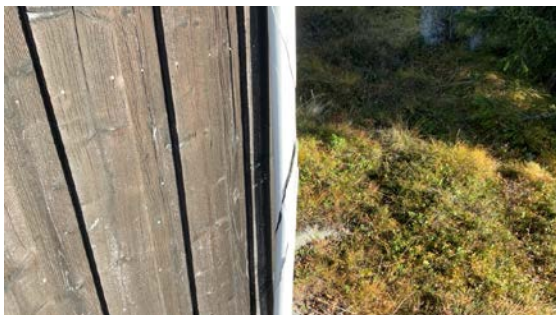
Skader på nedløp
