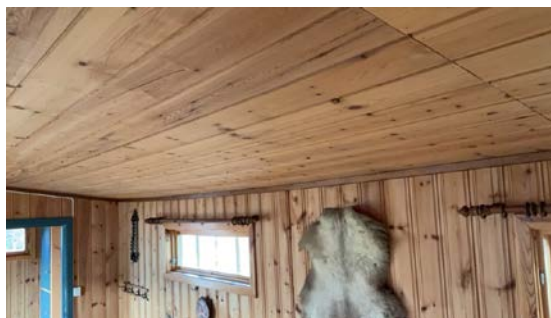
Det er registrert store skjevheter i tak og vegger
