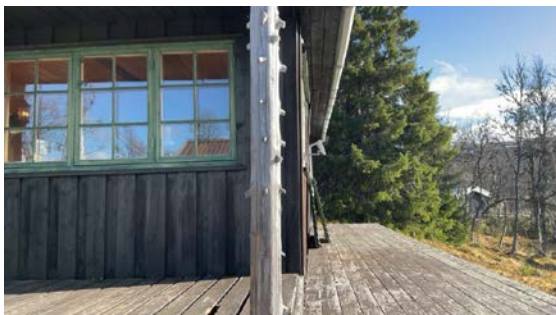
Skjevhet i vegg
