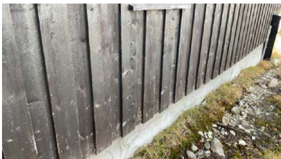
Slitasje og vedlikeholdsetterslep
