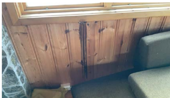
Det er fuktskjolder med avrenning på vegg ved vindu i stue
