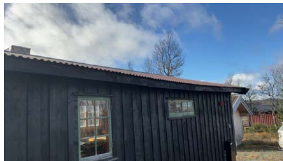
Skjevheter i takkonstruksjon
