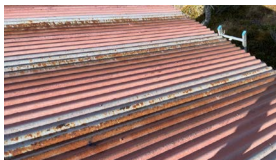
Rustskader på tekking
