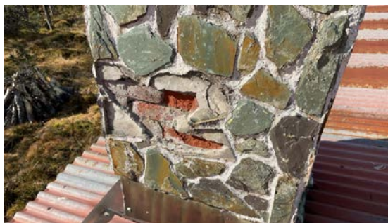
Skader på pipe over tak
