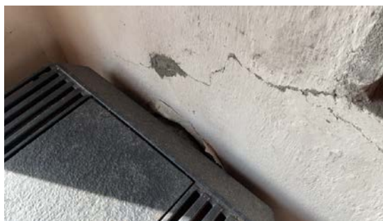
Avflassing bak vedovn mot pipe
