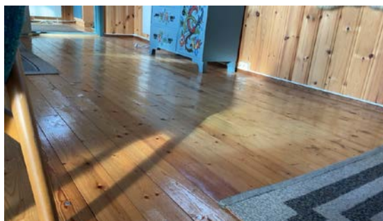
Det er registrert store skjevheter i gulv
