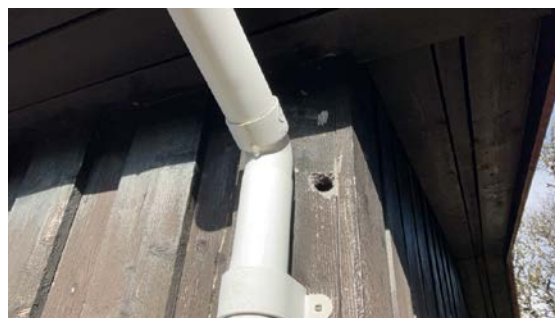
Skader med hakkespetthull
