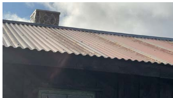
Spikeropptrekk på innfesting av tekking
