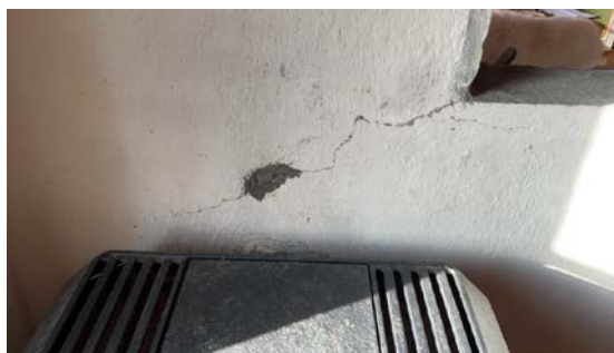
Sprekker i pipe/brannmur
