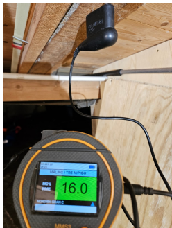
Fuktmåling i bjelkelag under hoveddel.
