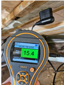
Fuktmåling i bjelkelag under tilbygg soverom.
