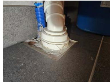
Rørgjennomføring i gulv
