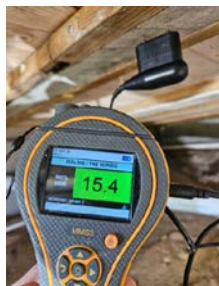
Fuktmåling i bjelkelag under tilbygg soverom.
