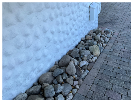
Ukjent løsning rundt garasjen.
