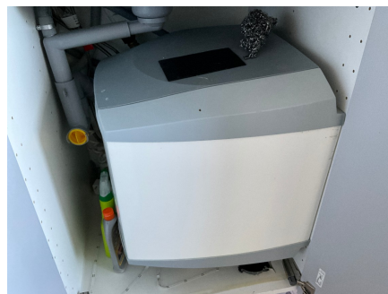
ca 50 liter og plassert i benkeskapet.
