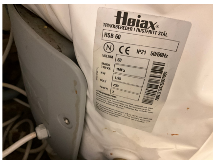
ca 60 liter og plassert i benkeskapet.
