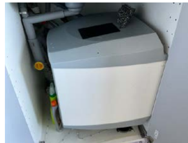
ca 50 liter og plassert i benkeskapet.
