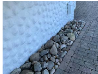
Ukjent løsning rundt garasjen.
