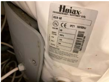
ca 60 liter og plassert i benkeskapet.
