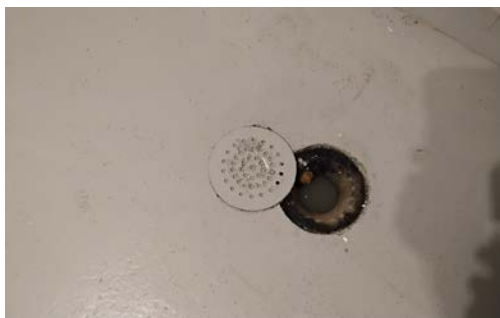
Støpejernssluk i kjellerrom
