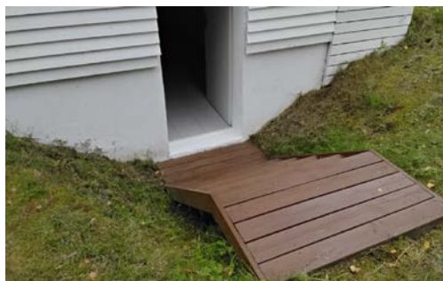
Trapp mangler rekkverk
