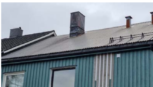
Avflassing i luftehatter og pipebeslag, og det er ikke montert snøfangere på hele takflaten.
