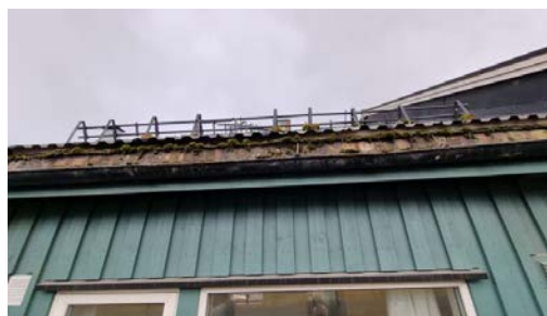
Spillblekk og takrenner er av eldre dato og har svekkelser.
