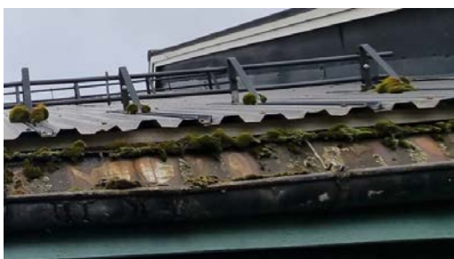
Det er ikke montert spillblekk fra spikerlekt og ned i takrenne.
