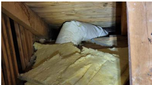
Ventilasjonskanal fra kjøkkenet på kaldloftet.
