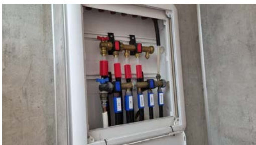
Kontroll av fordelerskapet.
