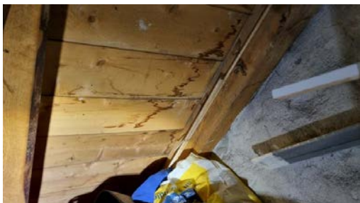
Stedvis fuktmerker og svertesopp i takkonstruksjonen på kaldloftet.
