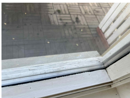
Malingsflass og slitasje
