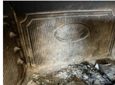
Sprekk i bennplate
