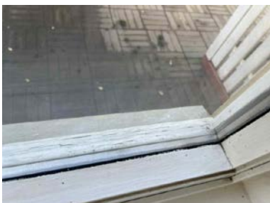
Malingsflass og slitasje
