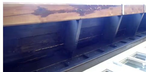
Sprekk i takrenne på hytte.
