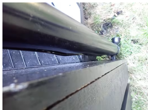
Nedløpsrør på annekset med buling/skade mot vegg.
