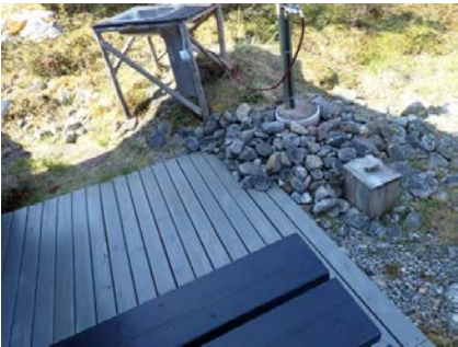
Skjevheten foreligger ut mot dette hjørnet.
