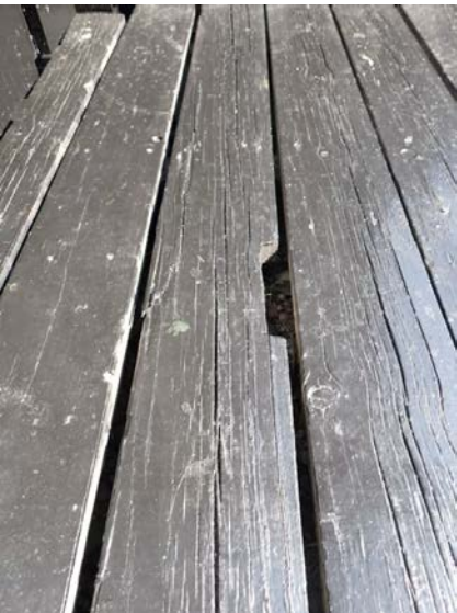
Noe sprekker i eldre bord.
