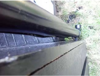
Nedløpsrør på anneks med buling/skade mot vegg.
