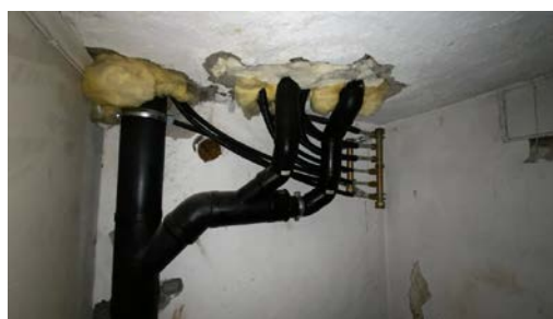
Det er ikke kontrollert avrenning fra vannrør til avløp i kjellerbod.
