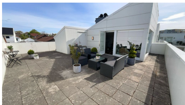
Betongherller ligger ujevnt og har noe bevegelse når man går på de.
