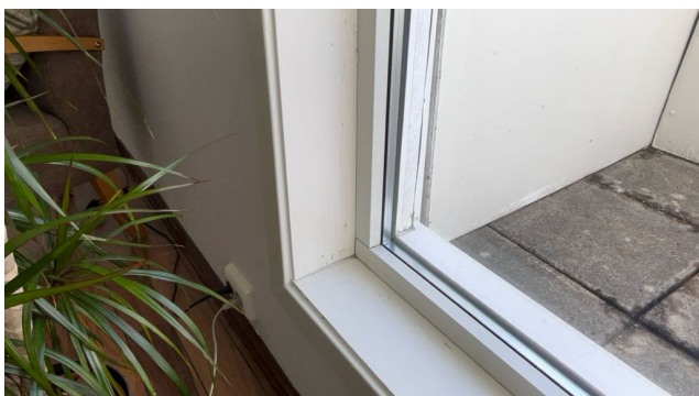
Spor etter fukt innvendig i karm
