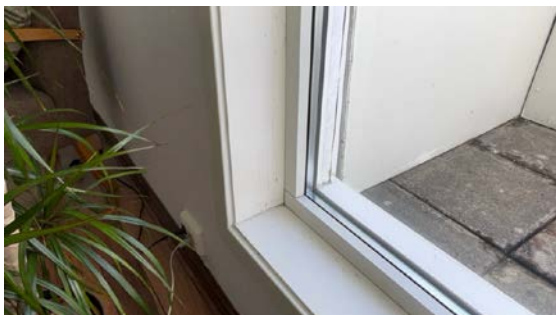
Spor etter fukt innvendig i karm
