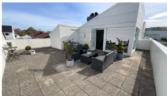
Betongheriller ligger ujevnt og har noe bevegelse når man går på de.
